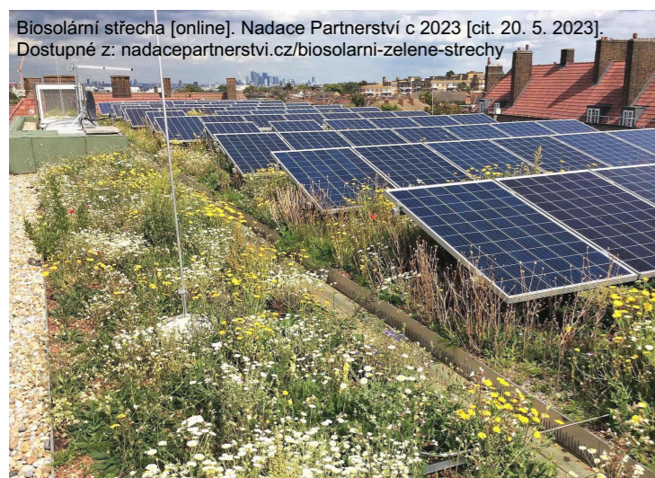
▲ BIOSOLÁRNÍ ZELENÁ STŘECHA • BIO-SOLAR GREEN ROOF KROMĚ VEGETACE ZAHRNÚJE TAKÉ FOTOVOLTAICKOU ELEKTRÁRNU • FVE, KTERÁ JE DÍKY NÍ OCHLAZOVÁNA A PRACUJE TAK S VYŠŠÍ ÚČINNOSTÍ
