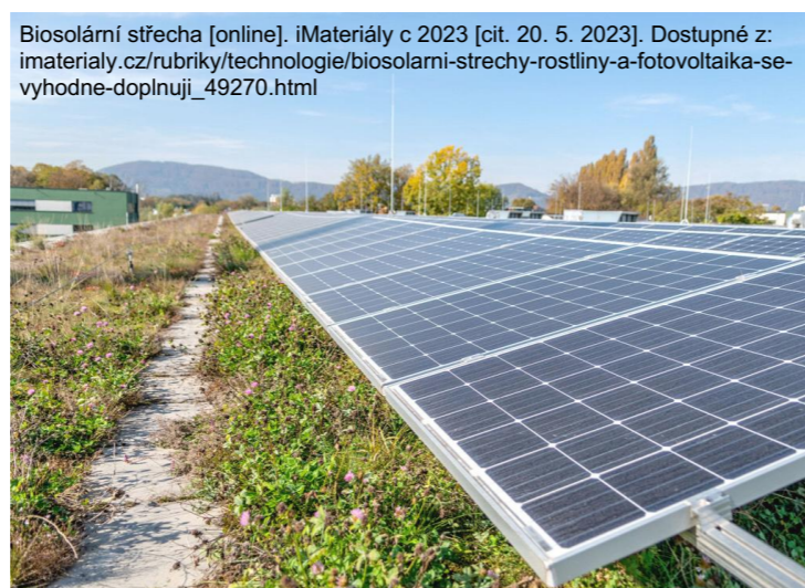
▲ VEGETAČNÍ SOUVRSTVÍ ZELENÉ STŘECHY SNIŽUJE POVRCHOVOU TEPLOTU VE SPODNÍ ČÁSTI PANELŮ, KTERÉ DÍKY TOMU VYROBÍ VÍCE ELEKTRINY A ZÁROVEŇ POSKYTUJÍ ROSTLINÁM STINNÁ STANOVISTĚ
