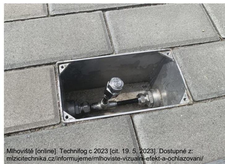
▲ VYSOKOTLAKÉ ČERPADLO ZVYŠUJE TLAK VODY NA 25 AŽ 100 BARŮ, A NÁSLEDNĚ JE VODA TRYSKAMI ROZMLŽENA NA KAPKY O VELIKOSTI 10 MIKROMETRŮ • SYSTÉM JE ÚČINNÝ PŘI TEPLOTÁCH OD 26 DO 45 °C
