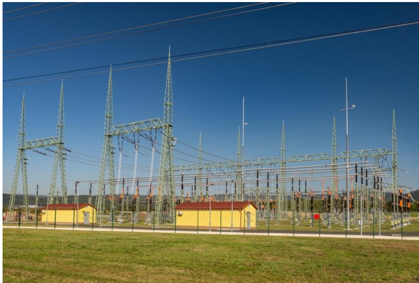
Obr. č.8 Nová rozvodna TR Verněřov 400-110 kV (Zdroj: Oficiální web společnosti STAVUM, spol. s.r.o.)
