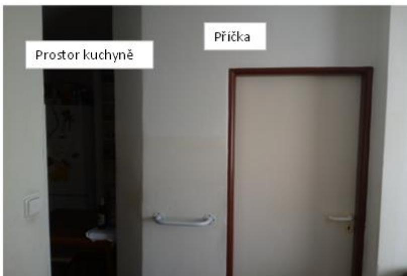
Obrázek 9 Nevhodně umístěná příčka, ztemňující prostor kuchyně, vlastní zpracování
