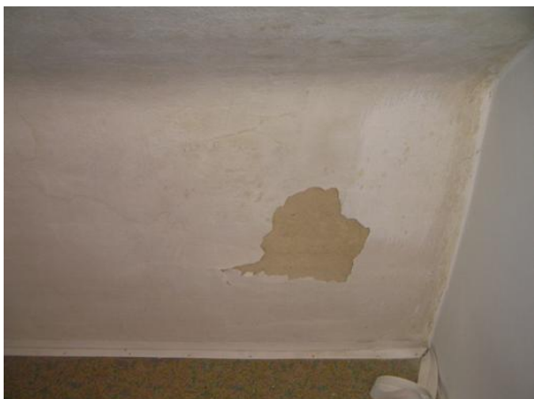
Obr.21 Zamokření podhledu následkem zatékání [44]
