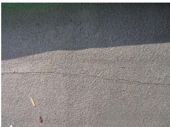
Obr.22 Trhlina v povlakové krytině způsobena nerovnoměrným sedáním [44]
