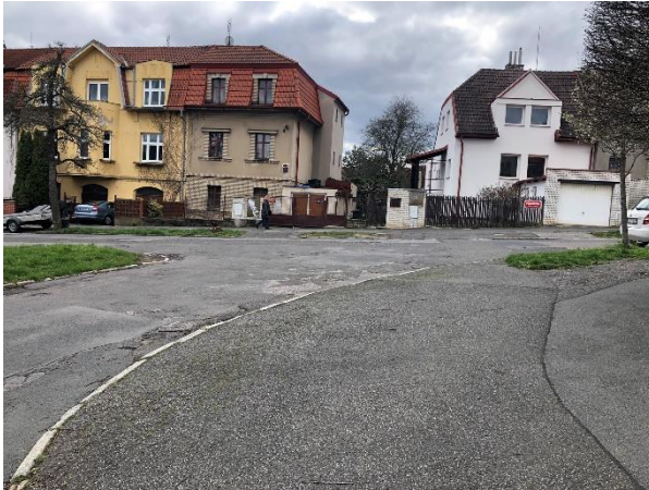
Obr. 17: Křižovatka č. 8 - Nevyhovující povrch komunikace 31
