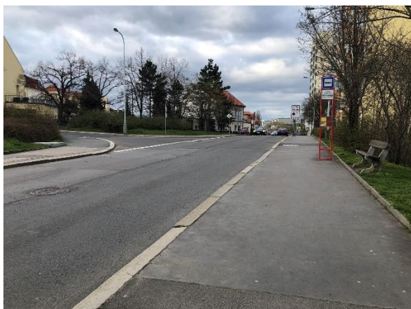
Obr. 34: Úsek č. 2 - Chybějící vodorovné dopravní značení zastávky autobusu 48
