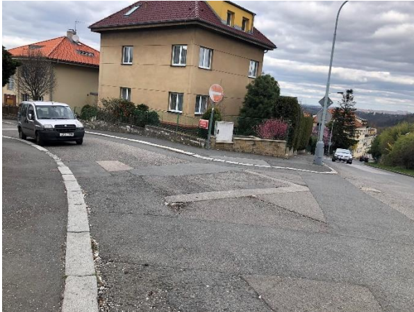
Obr. 20: Křižovatka č. 9 – Svislé dopravní značení v nevyhovujícím stavu 33
