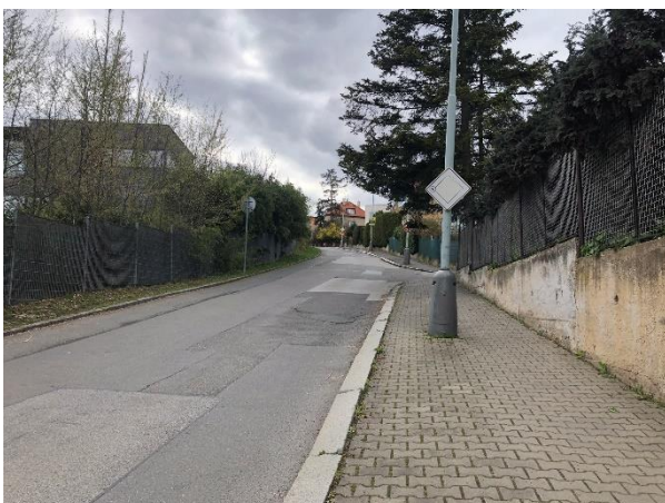
Obr. 45: Úsek č. 18 - Svislé dopravní značení v nevhovujícím stavu 58
