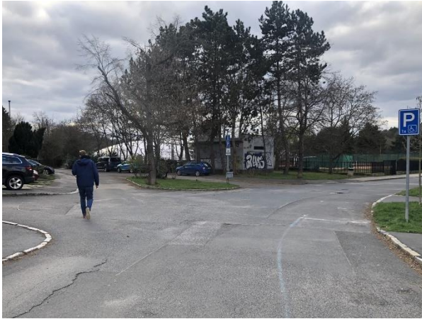
Obr. 29: Křižovatka č. 29 - Chybějící svislé dopravní značení 43
