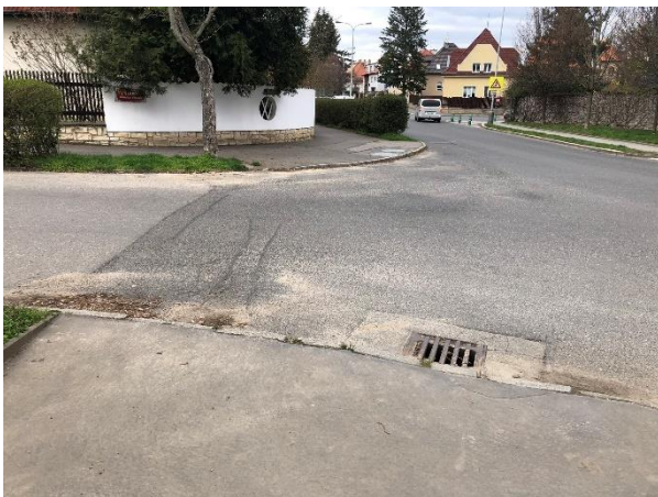
Obr. 13: Křižovatka č. 5 - Chybějící vodorovné značení pro OOSPO 27
