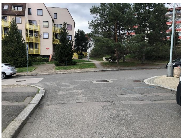
Obr. 32: Křižovatka č. 36 - Chybně provedené vodorovné značení pro OOSPO v místě pro přecházení 45
