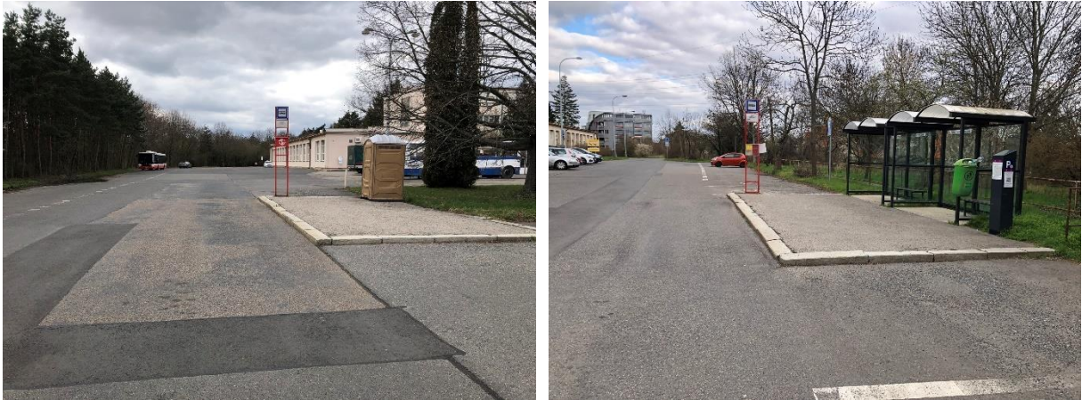
Obr. 52: Úsek č. 25 - Chybějící vodorovné dopravní značení zastávky autobusu 66
