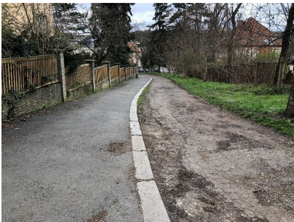
Obr. 55: Úsek č. 29 - Nevhodující povrch komunikace 69
