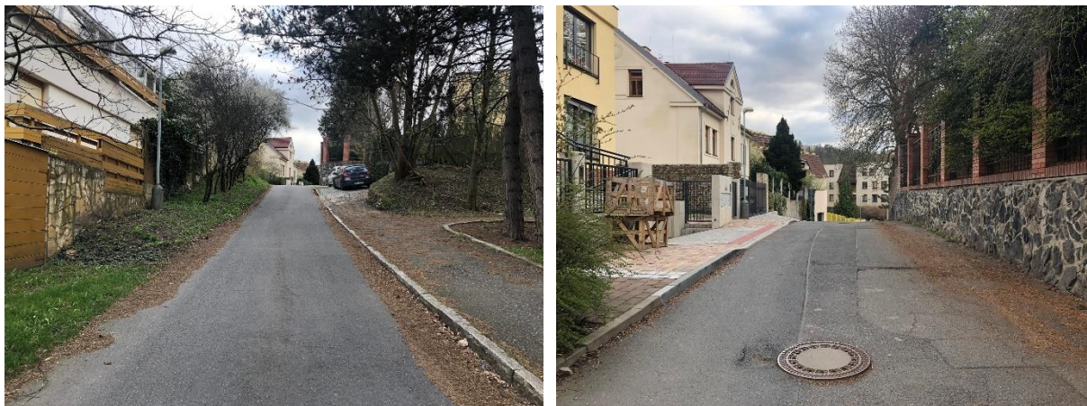
Obr. 65: Úsek č. 54 - Nedostatečný profil komunikace 80
