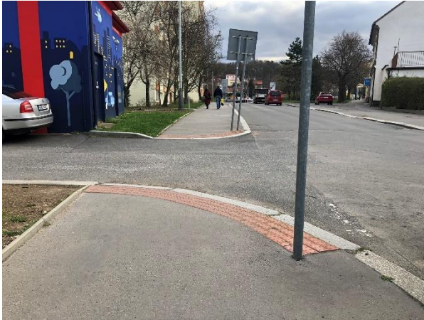
Obr. 11: Křižovatka č. 3 Chybně provedené vodorovné značení pro OOSPO v místě pro přecházení 25
