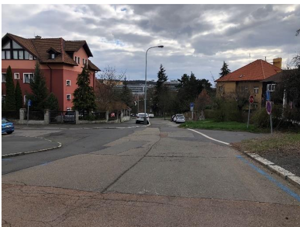
Obr. 23: Křižovatka č. 17 - Nevhodující povrch komunikace 36
