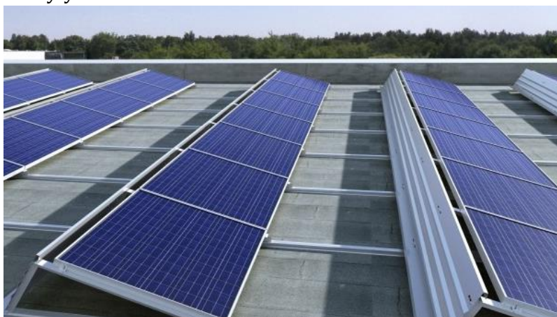
Obrázek 2-31: Příklad zakrytí zadní části konstrukce FV panelů plechovými kryty [48]
