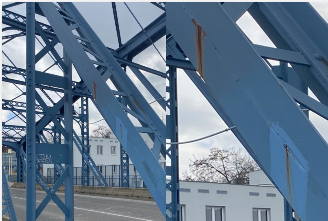
Obrázek 1: Koroze na mostní konstrukci
