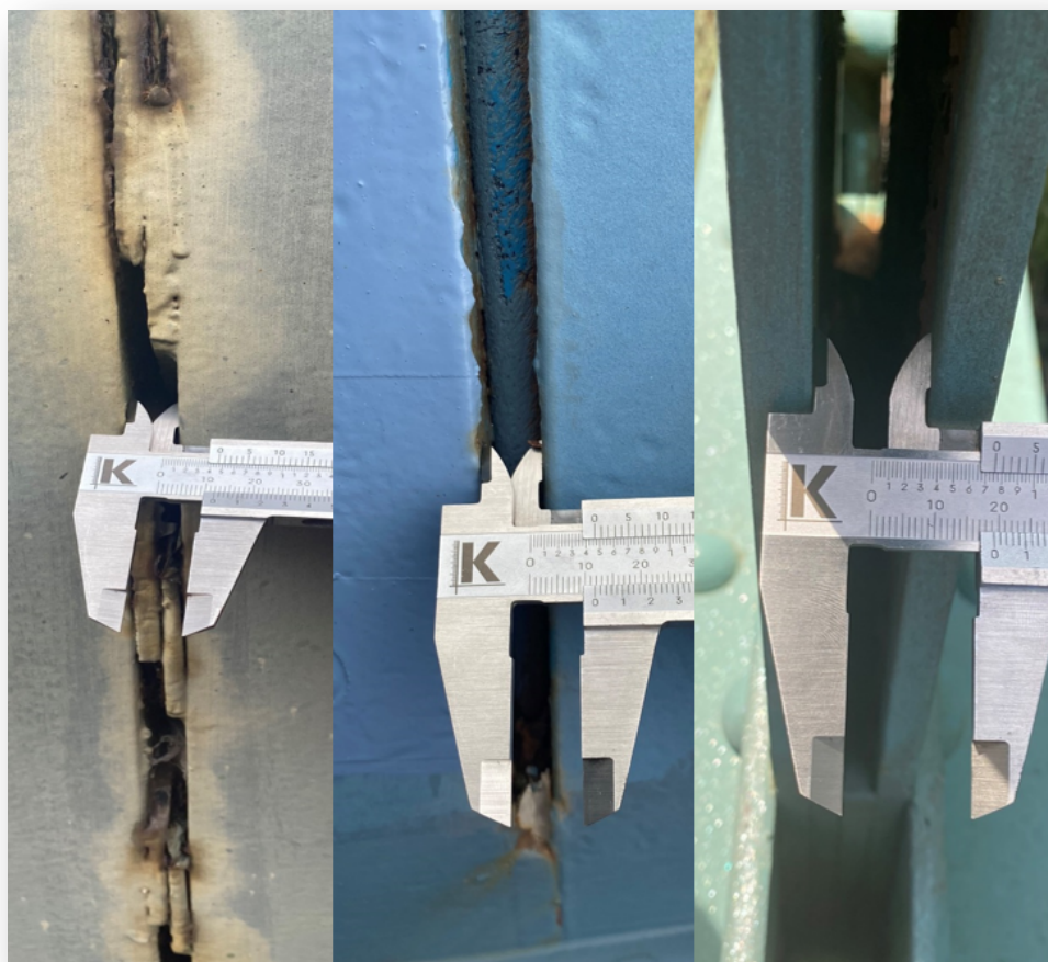
Obrázek 11: Korozní produkty uvnitř konstrukcí (vlevo – 5, uprostřed 6–a vpravo – 13)
