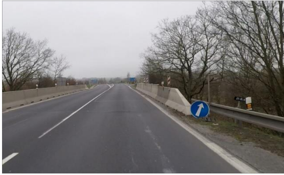
Obrázek 76 – Ilustrativní ukázka neadekvátně realizovaného přechodu mezi různými druhy svodidel na silnici I/21 ve směru proti staničení km 51,724. (ID 2531) [4] (PŘED ELIMINACÍ)
