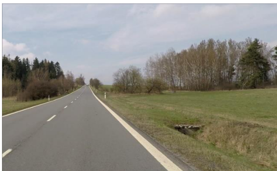
Obrázek 10 – Tuhé čelo propustku pod sjezdem představující pevnou překážku na silnici I/20 ve směru proti staničení km 37,821. (ID 1132) [4]
