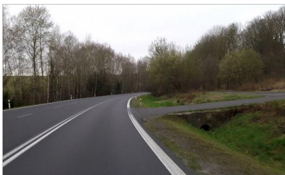
Obrázek 74 – Ilustrativní ukázka propustku pod hospodářským sjezdem na silnici I/21 ve směru staničení km 42,006. (ID 444) [4] (PŘED ELIMINACÍ)
