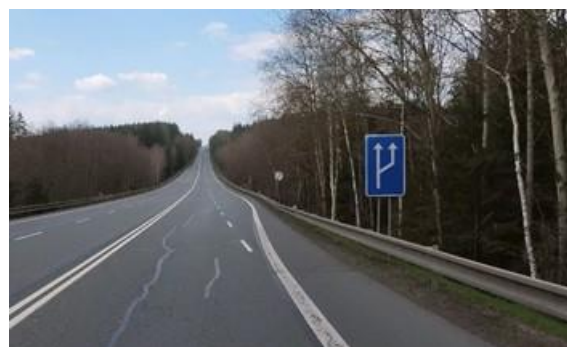
Obrázek 29 – Ukázka neadekvátního provedení změny počtu jízdních pruhů na silnici I/2 ve směru staničení km 30,079. (ID 3304) [4]
