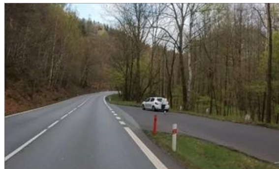
Obrázek 27 – Ukázka neadekvátního úhlu napojení komunikace na silnici I/13 ve směru proti staničení km 25,578. (ID 1070) [4]
