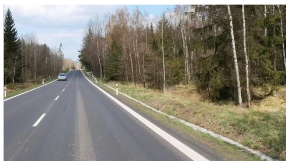
Obrázek 65 – Ilustrativní ukázka propustku pod hospodářským sjezdem na silnici I/20 ve směru proti staničení km 39,207. (ID 1075) [4] (PO ELIMINACI)
