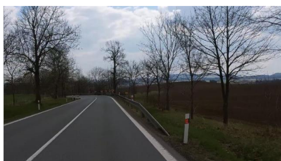
Obrázek 69 – Ilustrativní ukázka neadekvátního provedení svodidla na silnici I/20 ve směru staničení km 25,538. (ID 3355) [4] (PO ELIMINACI)
