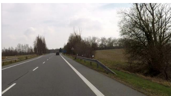
Obrázek 66 – Ilustrativní ukázka krátkého výškového náběhu svodidla na silnici I/20 ve směru proti staničení km 32,012. (ID 941) [4] (PŘED ELIMINACÍ)
