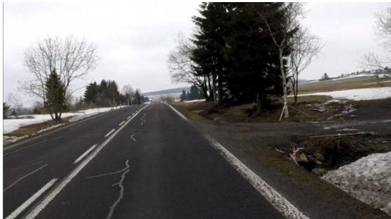
Obrázek 84 – Ilustrativní ukázka propustku pod hospodářským sjezdem na silnici I/25 ve směru staničení km 11,797. (ID 1287) [4] (PŘED ELIMINACÍ)
