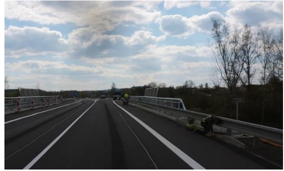
Obrázek 77 – Ilustrativní ukázka neadekvátně realizovaného přechodu mezi různými druhy svodidel na silnici I/21 ve směru proti staničení km 51,724. (ID 2531) [4] (PO ELIMINACI)
