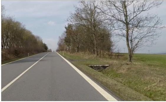
Obrázek 12 – Tuhé čelo propustky pod sjezdem představující pevnou překážku na silnici I/20 ve směru proti staničení km 37,4026. (ID 1147) [4]
