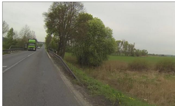
Obrázek 43 – Ukázka nenormovaného svahu zemního tělesa na silnici I/6 z databáze silniční sítě TEN-T ve směru staničení km 45,381. (ID 19903) [4]
