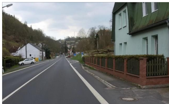
Obrázek 39 – Ukázka neadekvátně vyvýšeného chodníku vůči vozovce na silnici I/20 ve směru staničení km 20,162. (ID 2922) [4]
