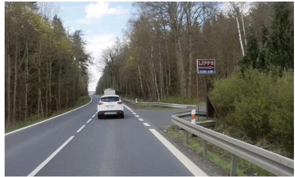
Obrázek 93 – Ilustrativní ukázka propustku pod sjezdem na silnici I/64 ve směru staničení km 8,248. (ID 240) [4] (PO ELIMINACI)
