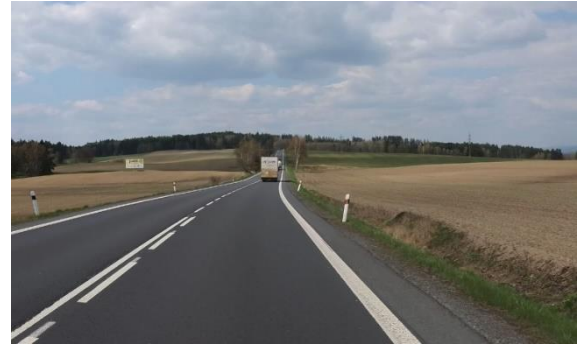
Obrázek 7 – Eliminace stromu odstraněním na silnici I/21 ve směru staničení km 39,475. (ID 422) [4]
