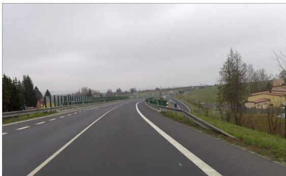
Obrázek 20 – Krátké svodidlo před mostem na silnici I/21 ve směru proti staničení km 28,954. (ID 2318) [4]
