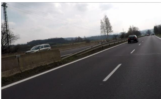
Obrázek 56 – Ilustrativní ukázka absence propojení mezi různými typy svodidel na silnici I/13 ve směru proti staničení km 6,546. (ID 1665) [4] (PŘED ELIMINACÍ)
