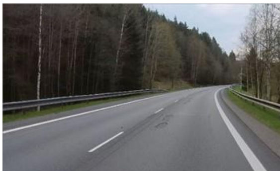
Obrázek 41 – Ukázka výtluků na silnici I/20 ve směru staničení km 9,417. (ID 3979) [4]
