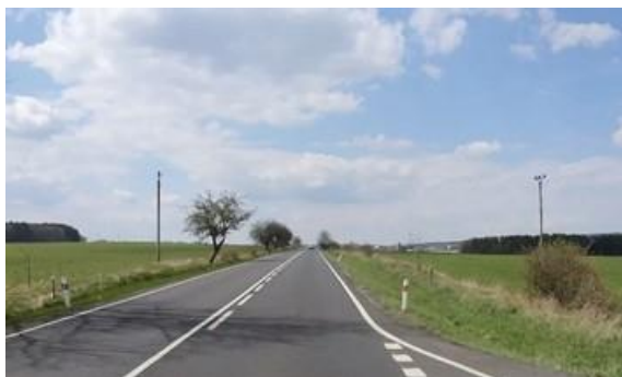
Obrázek 40 – Ukázka absence zpevněné krajnice na silnici I/64 ve směru staničení km 3,094. (ID 3112) [4]
