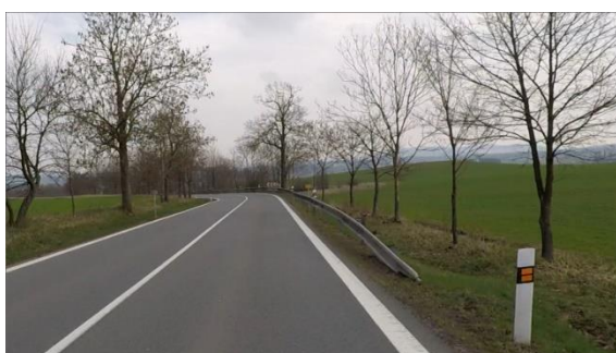
Obrázek 68 – Ilustrativní ukázka neadekvátního provedení svodidla na silnici I/20 ve směru staničení km 25,538. (ID 3355) [4] (PŘED ELIMINACÍ)
