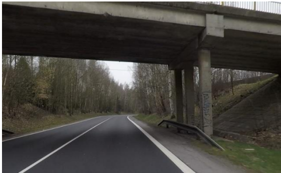
Obrázek 18 – Nedodržení minimální vzdálenosti za svodidlem na silnici I/64 ve směru staničení km 5,187. (ID 209) [4]
