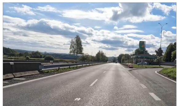
Obrázek 57 – Ilustrativní ukázka absence propojení mezi různými typy svodidel na silnici I/13 ve směru proti staničení km 6,546. (ID 1665) [4] (PO ELIMINACI)
