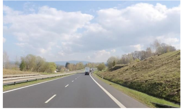
Obrázek 53 – Ilustrativní ukázka liniové vegetace v těsné blízkosti komunikace na silnici I/13 ve směru staničení km 2,105. (ID 495) [4] (PO ELIMINACI)
