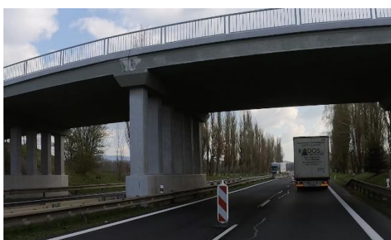
Obrázek 24 – Ukázka nedodržení minimální vzdálenosti za svodidlem na silnici I/13 ve směru staničení km 5,338. (ID 549) [4]
