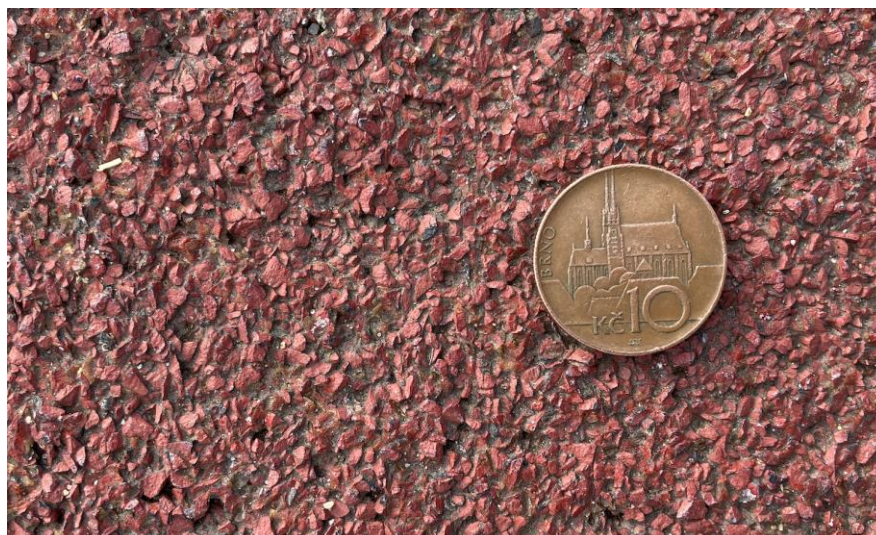
Obrázek 34 - Charakteristický snímek bezpečnostní protismykové úpravy 6F
