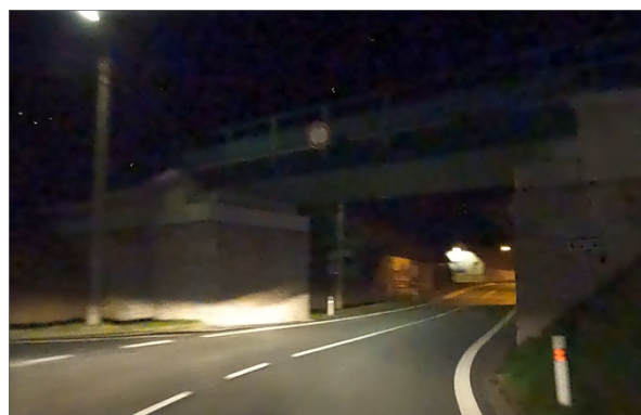
Obrázek 78 – Neadekvátní postřehnutelnost pevné překážky (PLZ | ID 3631). [5]
