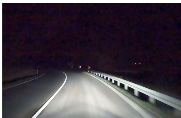
Obrázek 19 – Neadekvátní světelně-technické vlastnosti DZ (JCK | ID 40933). [5]
