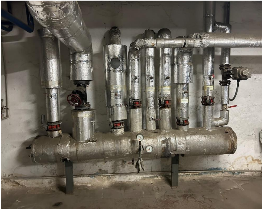
Obr. 4.16 - Rozdělovač a sběrač topné vody ve staré hale
