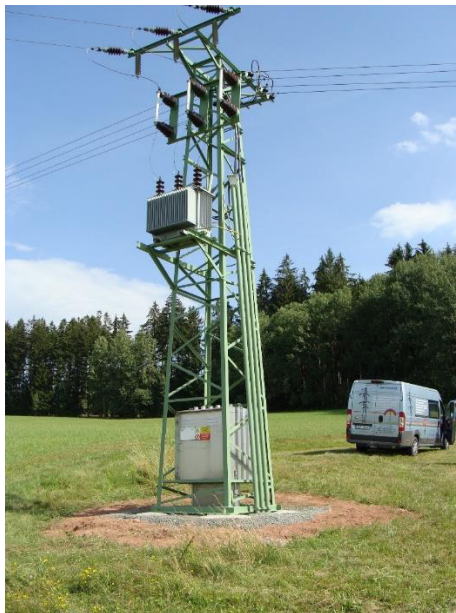
Obr. 3: Sloupová distribuční trafostanice úroveň VN [C]
