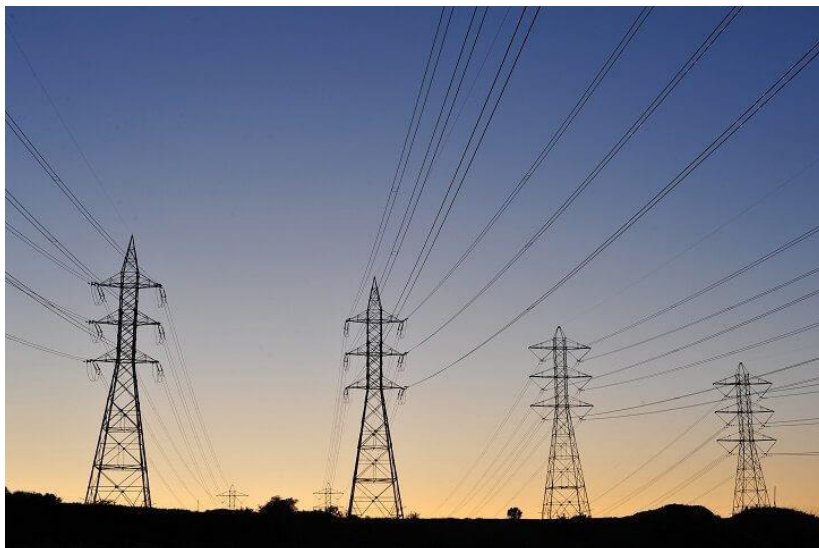
Obr. 2: Příhradové stožáry úrovně VVN [B]
