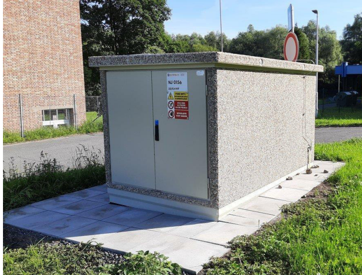
Obr. 5: Kiosková trafostanice [E]
