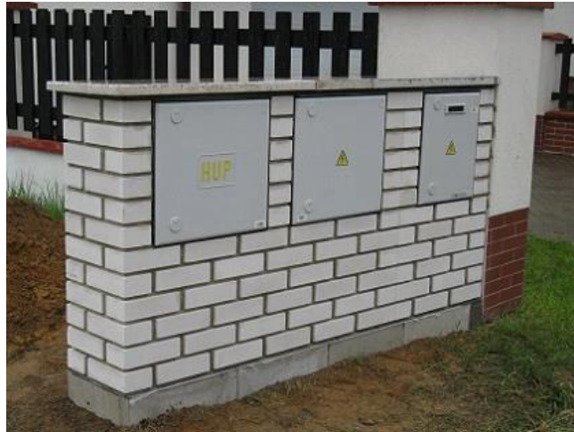
Obr. 4: Připojení odběratele na úrovni nízkého napětí (přípojková a elektroměrová skříň) [D]
