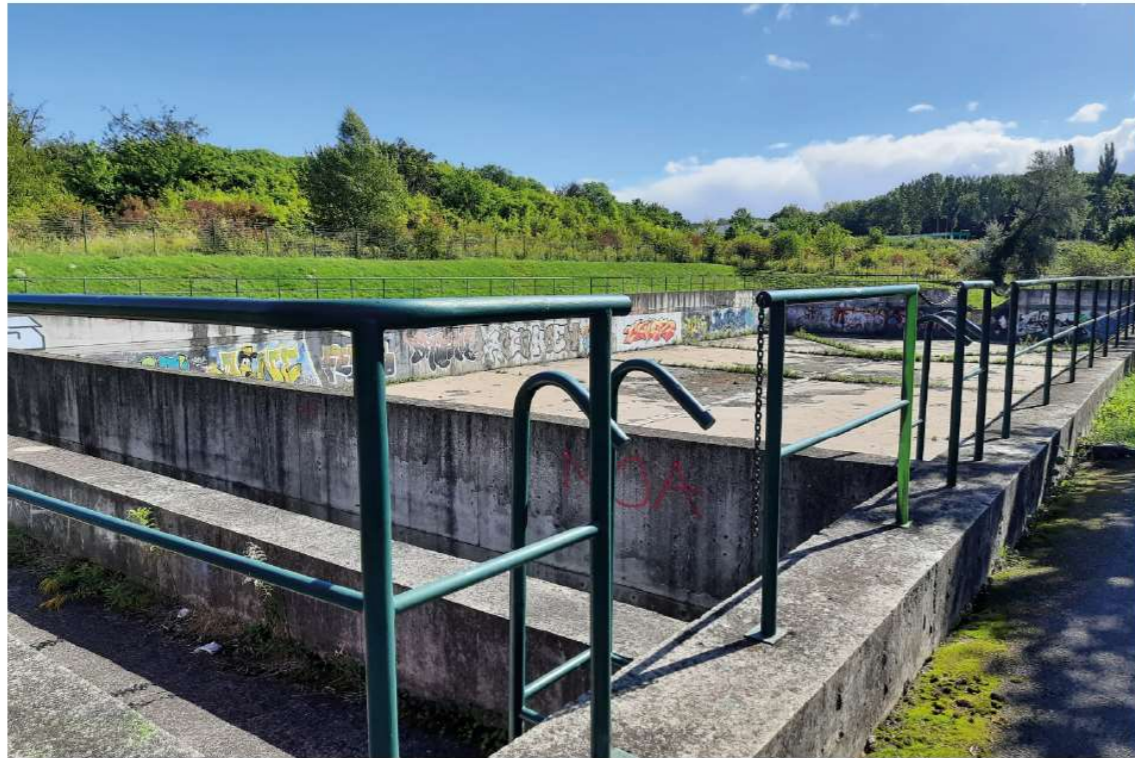
retenční nádrž zdroj: vlastní fotografie autorky
