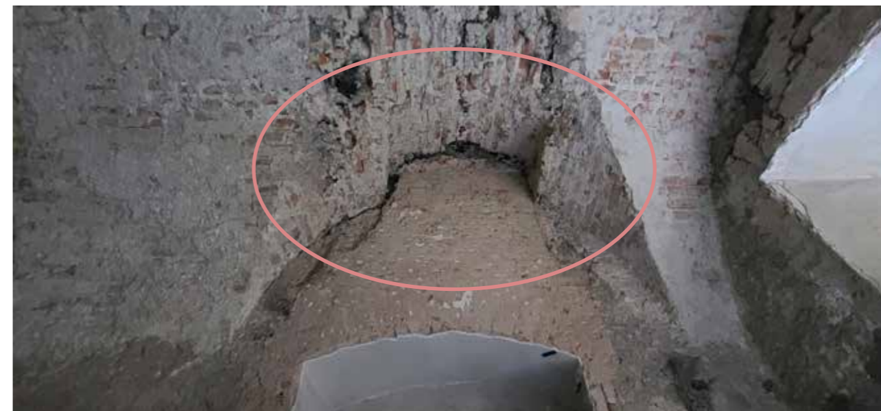
obr.62: Místnost 1.04, druhotné vložení pece pro barokní kuchyň
