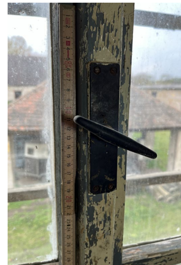
detail bakelitové rozvory vnitřní rovina
