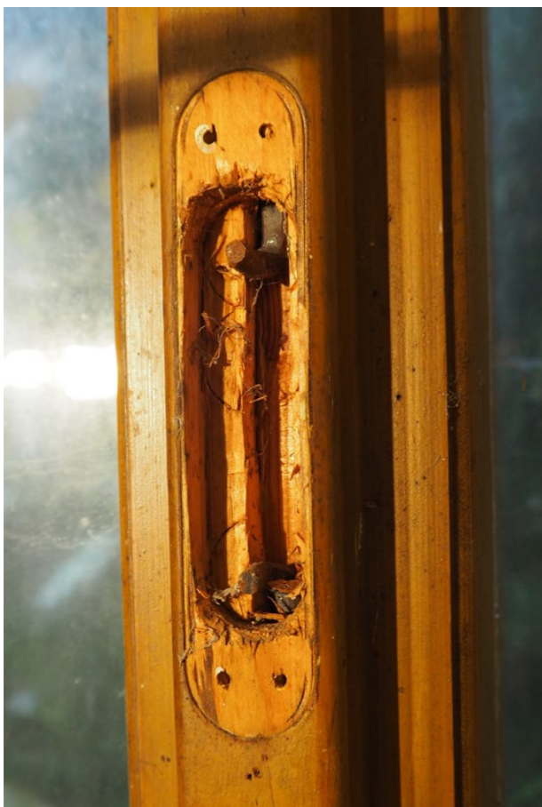
otisk po štítku na klapačce dvoukřídla vnitřní rovina
