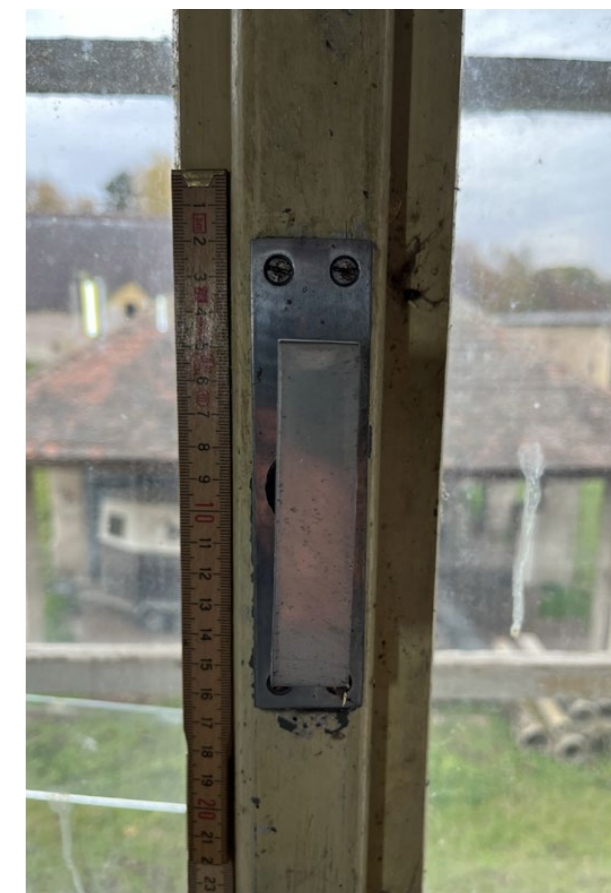
detail bakelitové rozvory vnitřní rovina
