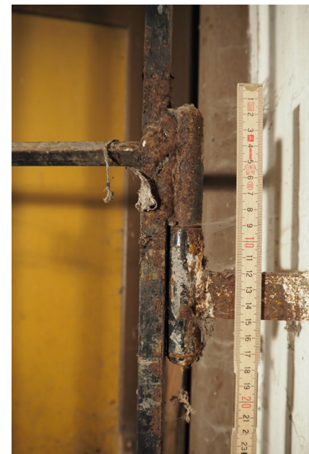
detail závěsu a kotvení trnu do ostění mříže u lícové strany dveří
