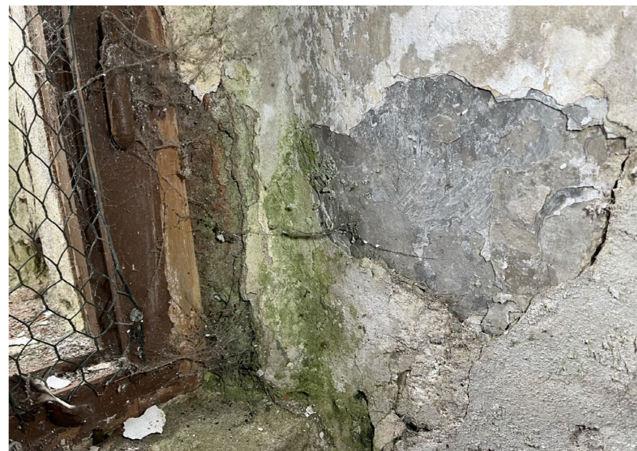
spodní jižní roh, okenní rám s trnem omítkové souvrství ostění vnitřní rovina
