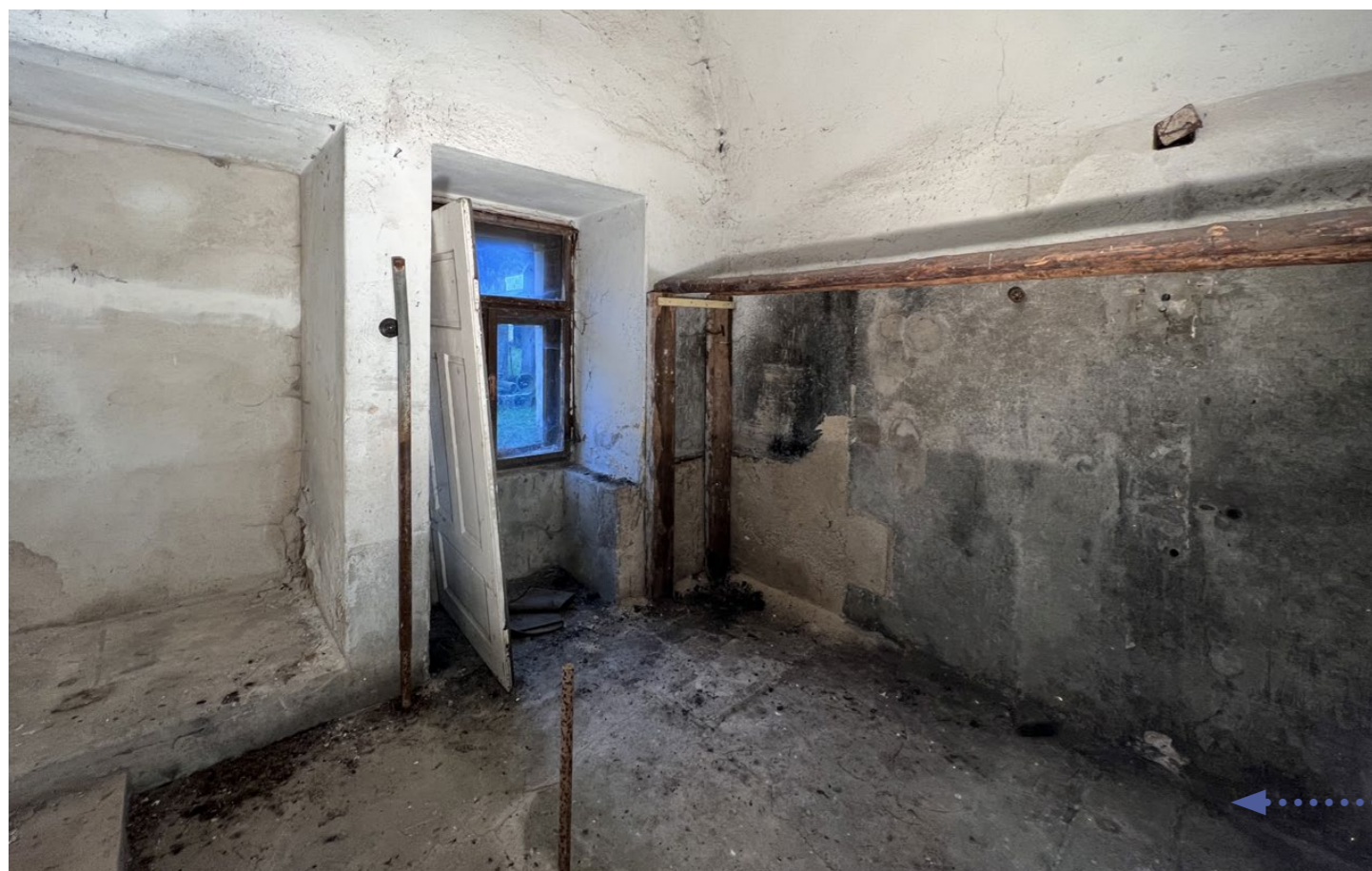
místnost 1.1a: pohled severozápadní na zeď s otisky po příčkách
