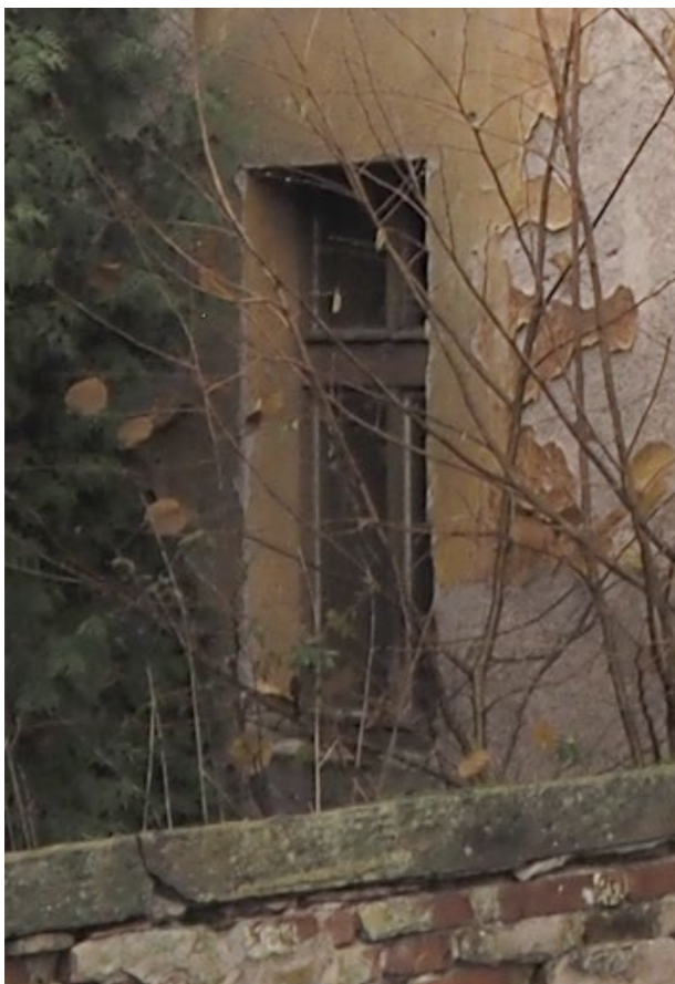
situace na fasádě kolem okna O.11 severní fasáda
