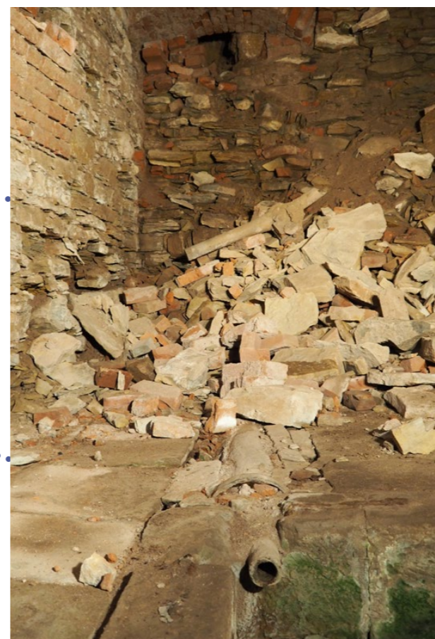
mléčný sklep: trubka v kamenné podlaze ústí do nádrže, v pozadí nika v závalu
