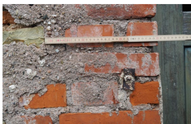
rozsah cihelné přezdívký ostění neidentifikovaný kovový prvek
