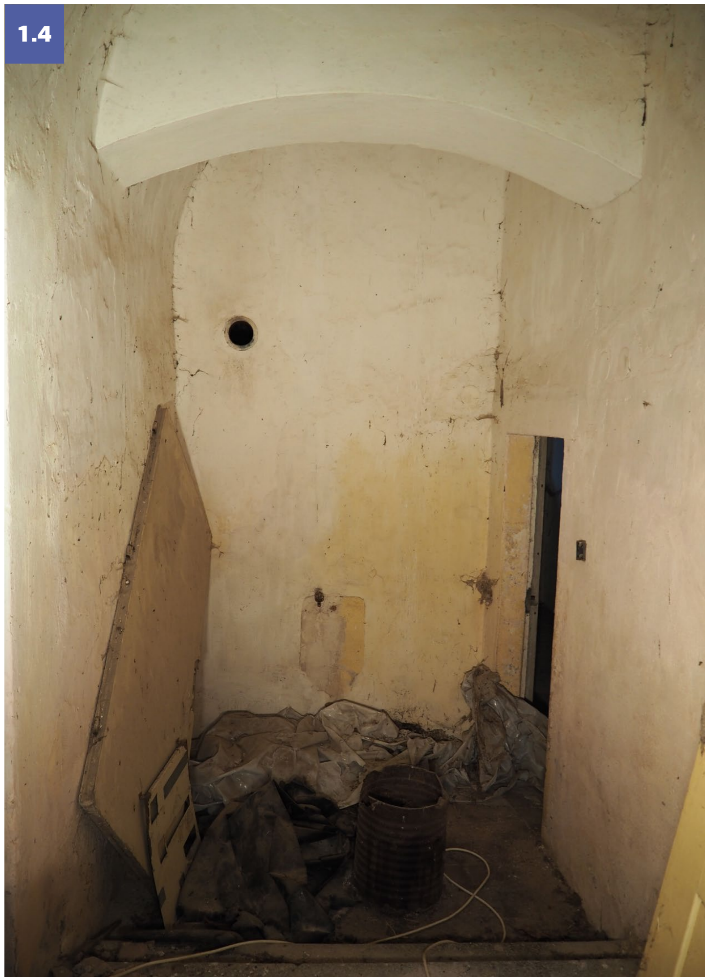
síň 1.4: pohled východní, směrem ke dveřím do chodby 1.2 otvor po kouřovém tahu, otisk po snesené výlevce, pod pasem dva stupně pro vyrovnání výškových úrovní mezi navýšeným terénem dvora a původní výškou podlahy v přízemí
