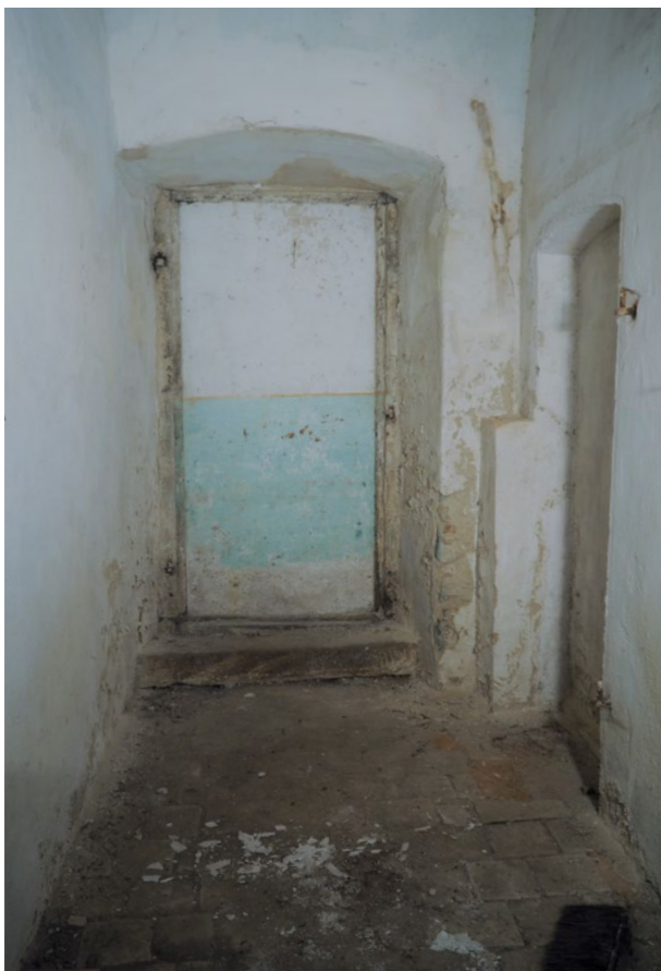
pohled na situaci zadržky otvoru chodba 1.2
