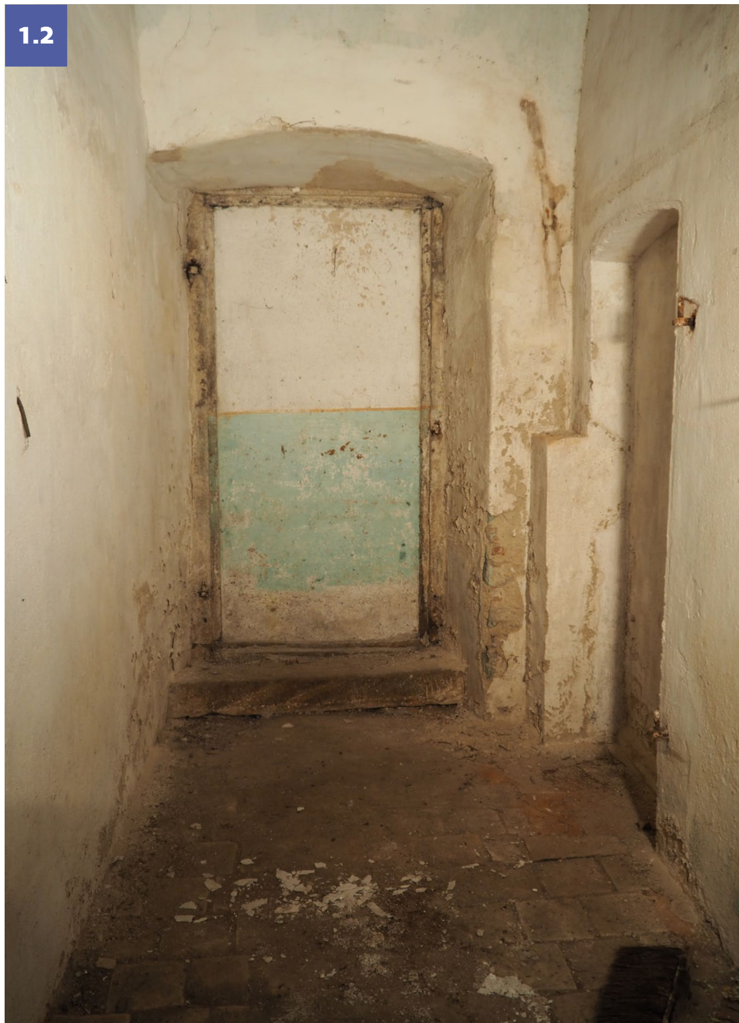
chodba 1.2 vydělená z komory pro žrádlo pohled na jih (ke kravínu), pod bílým nátěrem modrý nátěr s oranžovým pruhem jako na zazdívce zazděné dveře D.08 do kravína, zazděný vstup do již zaniklé kóje vydělené v 1.1
