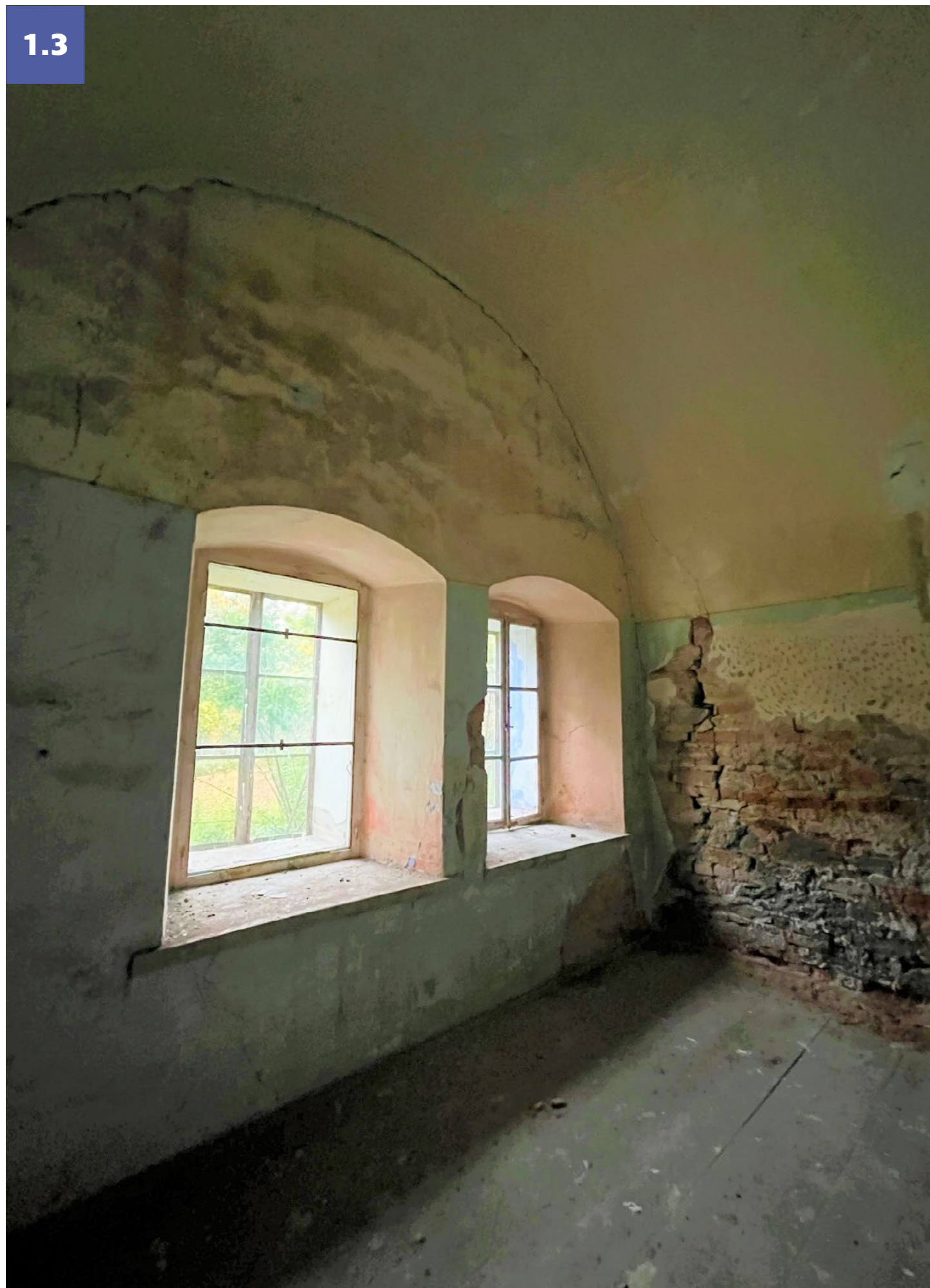
místnost 1.3: pohled jihovýchodní na dvojici oken 0.6 (posun) a 0.7 (průraz)
