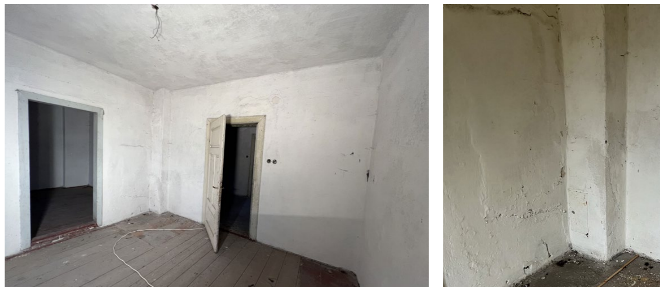
místnost 2.12: pohled jihozápadní, proražené dveře D.26, vstupní dveře D.28 detail omítkové opravy zadržky na jižní stěně u komína a vymetací dvířka u podlahy
