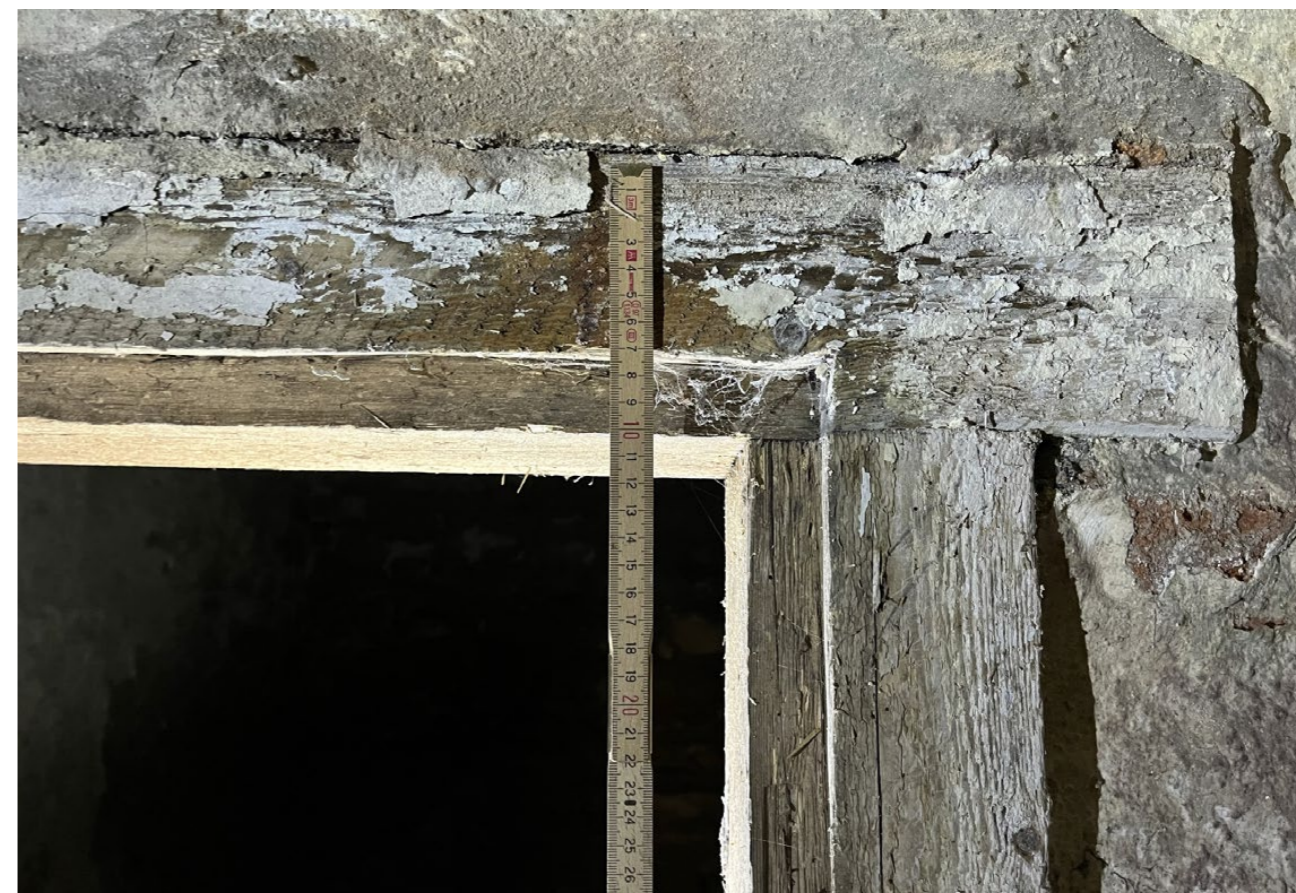
severní horní roh trámkové zárubně s bílým nátěrem, kolem omítkové opravy pohled z kuchyně 0.2
