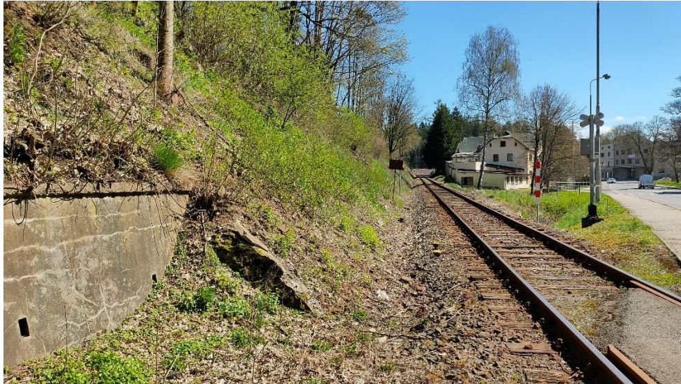
Obrázek 79 – Místo prověřované zastávky Jilemnice dolní Nástupiště zastávky je navrženo z pohledu fotografa vlevo od koleje. To si vyžádá zemní práce spojené s prodloužením zárubní zdi viditelné na fotografii.
