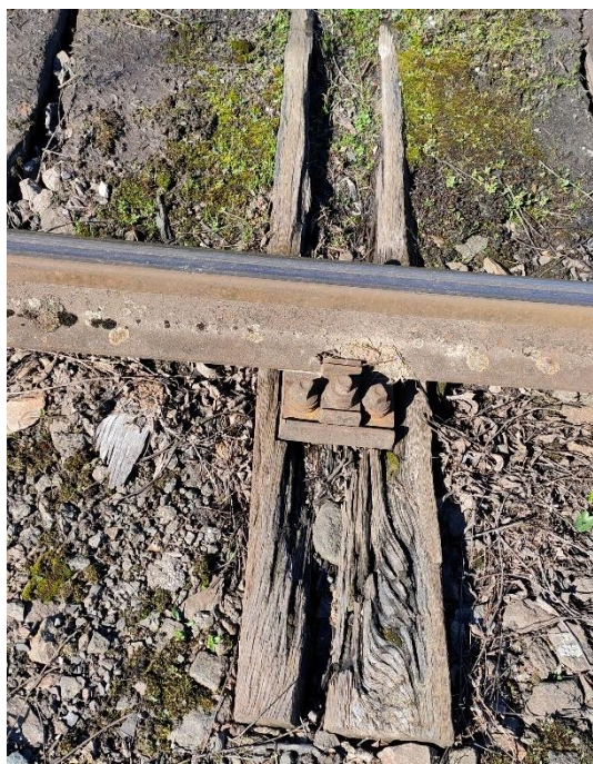
Obrázek 1 – Poškozený dřevěný pražec
