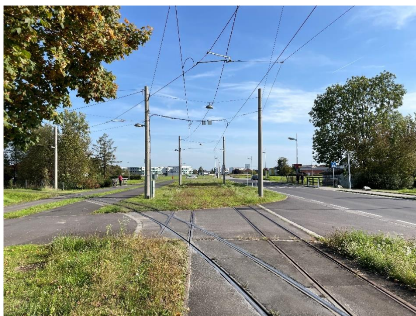
Obrázek 30 Již postavené koleje v přímém směru pro budoucí prodloužení tramvajové tratě k jezeru Pichlinger See (foto: autor, říjen 2022)
