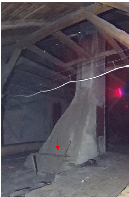
Obr. 135: Prostor napojený na komín 2. DČK v prostoru půdy od severozápadu, výřez ze snímku sférické foto-kamery. Šipka ukazuje zúžení stěny DČK
