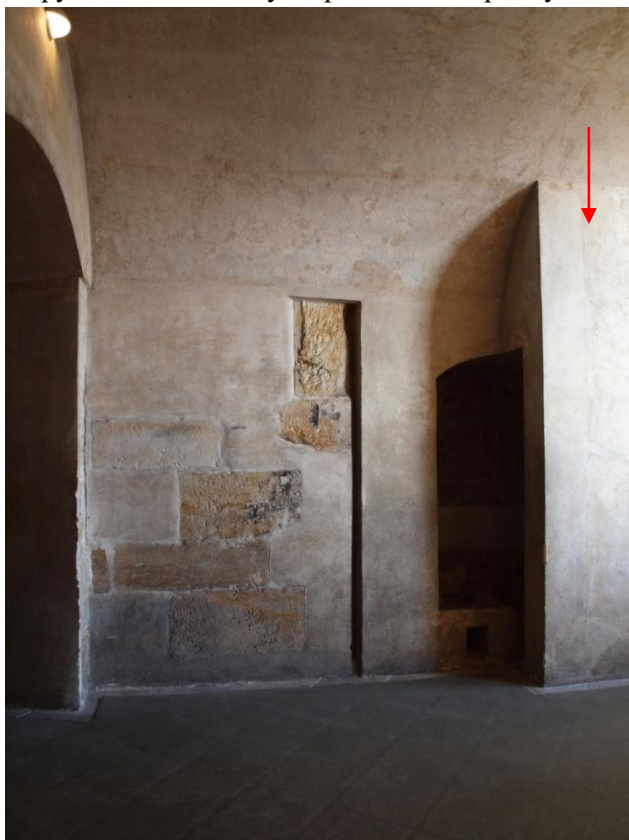
Obr. 23: NP4. Pohled na odkryté topeniště a pozůstatky krbu Stopy kletované omítky na přední straně příčky
