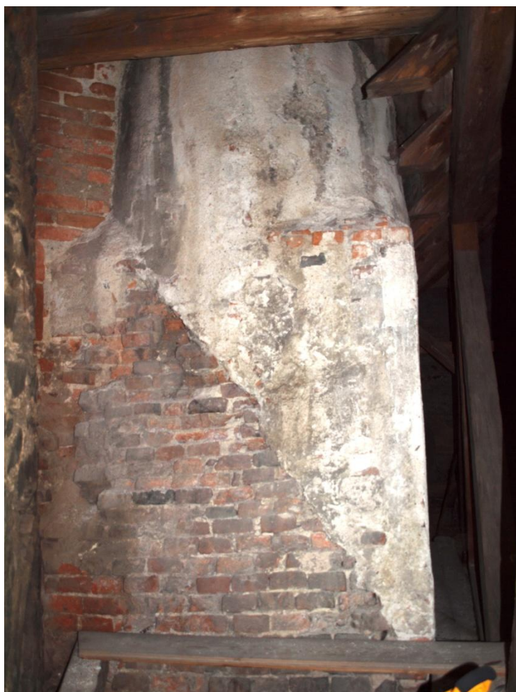
Obr. 8: DČK kuchyně 1A a na ni navazující svislá část komína na půdě starého paláce. Rozhraní omítka - režné zdivo ukazuje sklon střechy před navýšením tohoto traktu o patro, v němž se nachází kuchyně 1B. Hmota komína kuchyně 1A a jeho ozdobná hlavice se ulatňovala v pohledech na hrad (Menhartka v té době ještě nestála).
