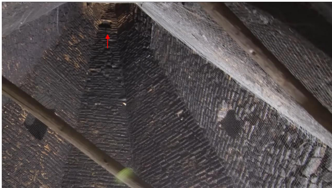
Obr. 8: Pohled do DČK z komína. Šipka označuje jeden z otvorů v horní části DČK. Dostupné z: https://www.youtube.com/watch?v=hbJj5wT7-CU
