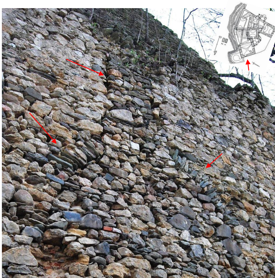
Obr. 19: Jihovýchodní stěna kuchyně, vylehčovací oblouk, foto a výřez. Foto J. Serafin 2018.
