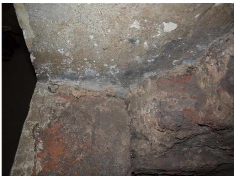
Obr. 28. NP4. Původní omítka a nátěry za topeništěm, levá špaleta niky
