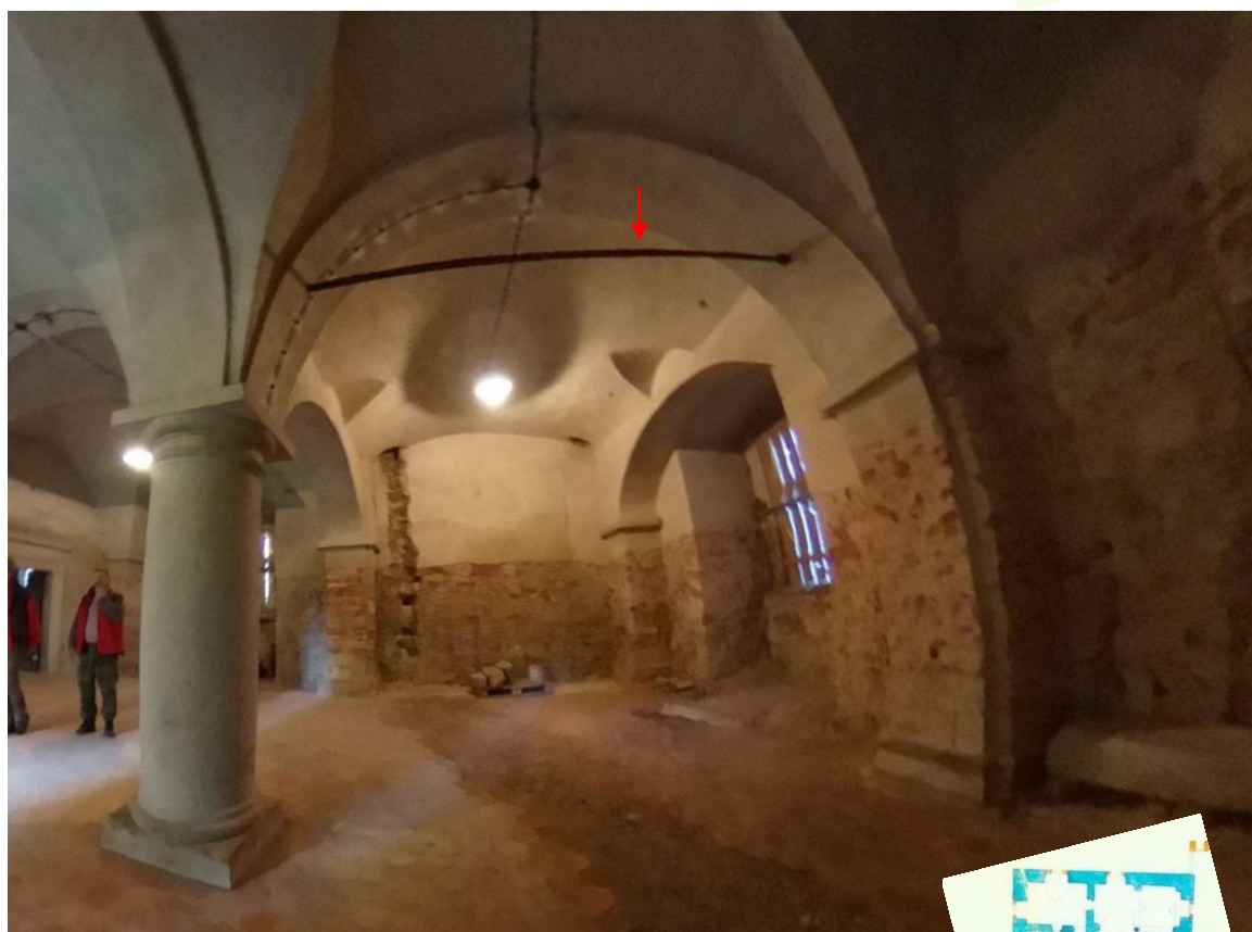
Obr. 3: Kuchyně 1, šipka označuje železný pásek, výřez ze snímku sférické foto-kamery.
