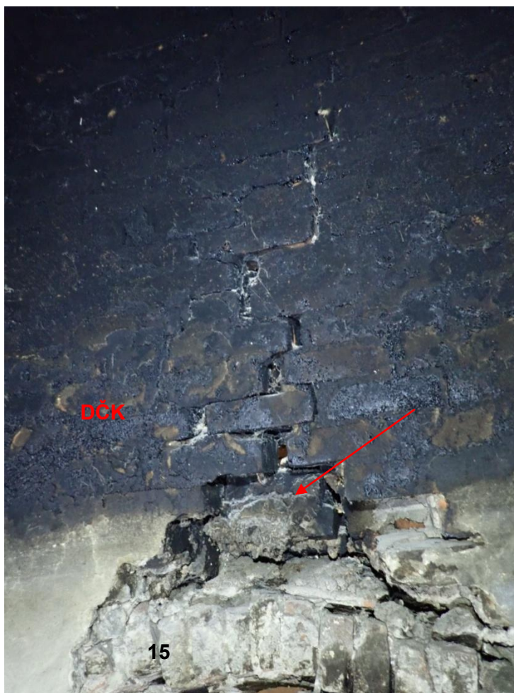
Obr. 85: Kuchyně 3. Uvolněná cihla - kritické místo DČK, které hrozí nebezpečí zřícením a je třeba ho urychleně zajistit, oba záběry výřezy ze snímku sférické foto-kamery.
