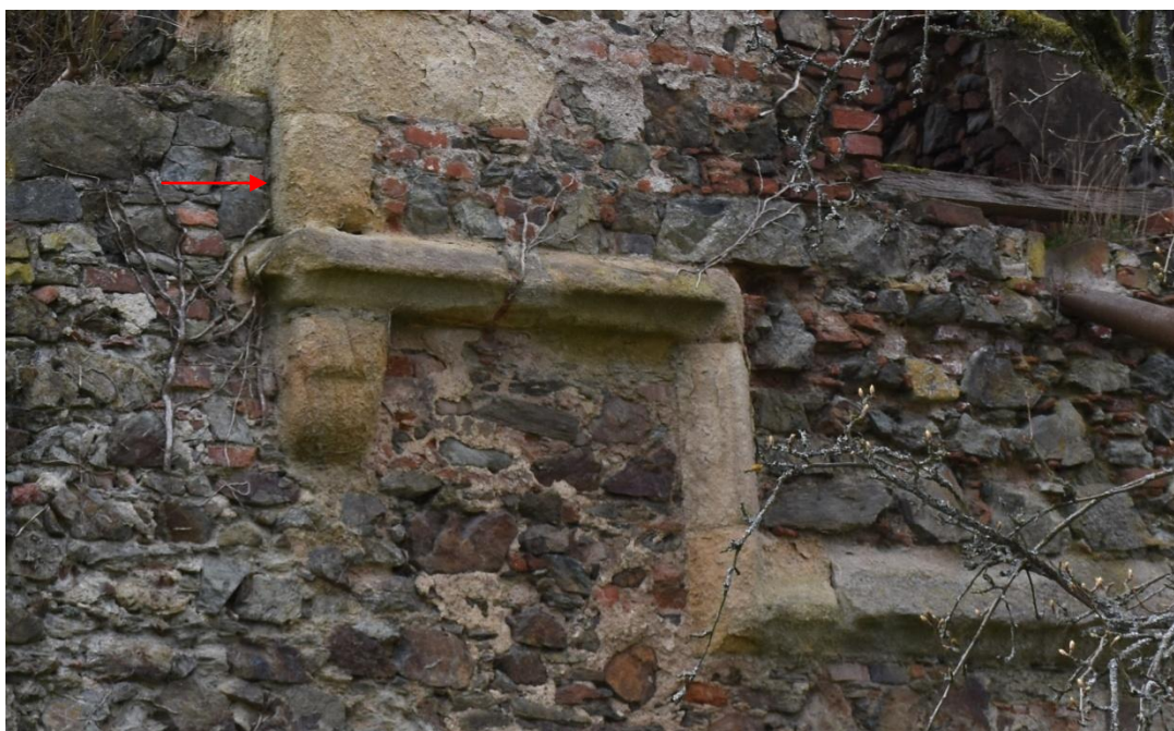
Obr. 10: Detail zakončení římsy. Šipka označuje předstupující zdivo 1. patra.
