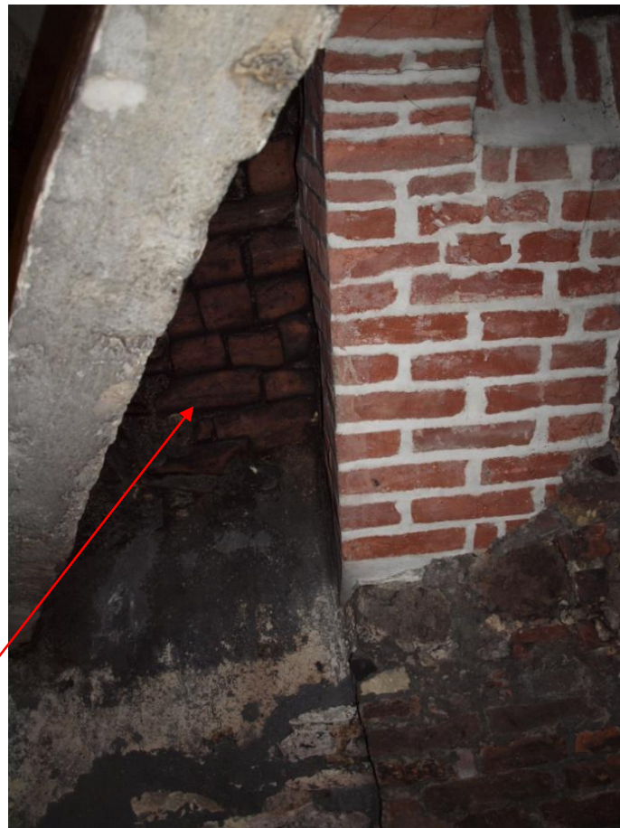
Obr. 15: NP3. Nový cihlový pas, který částečně zakryl stopy po odbourání staršího pasu. Pohled od topeniště směrem vzhůru
