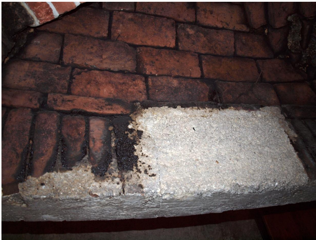
Obr. 17: NP3. Přímý oblouk vynášející dýmník vyspravený pravděpodobně cementovou maltou.
