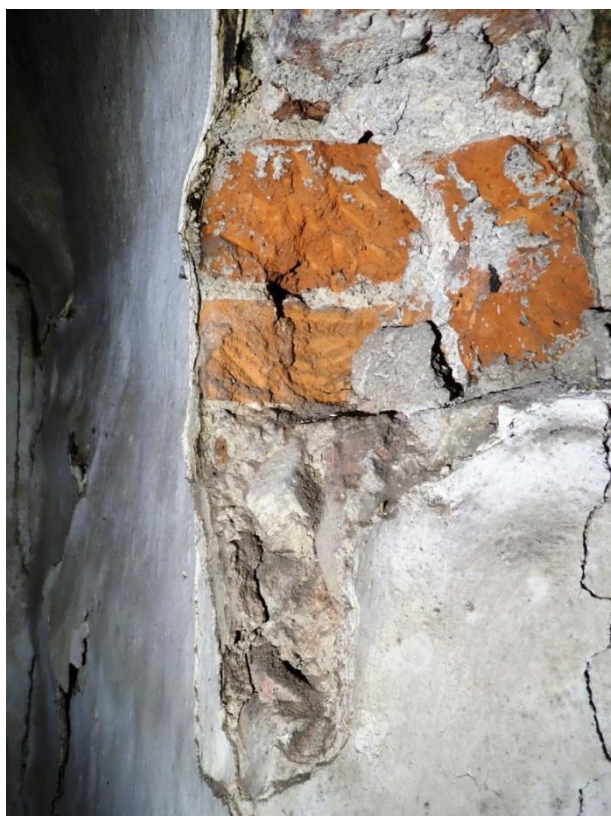
Obr. 79: Kuchyně 3. Severní špaleta staršího okna, přitesané cihly a nároží špalety z úlomků cihel a malty.
