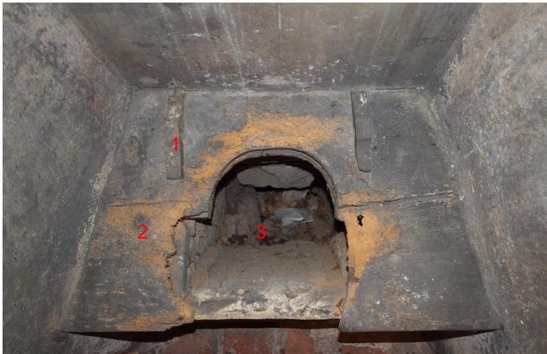
Obr. 19: NP3. Prevet v nice okna. Omítky výklenku přiléhají k dřevěnému prkénku prevetu. 1 - úchyty krytu prkénka (2), který se nedochoval. Ústí prevetu do šachty - 3 - je z větší části zaplněné odpadky, které nebylo možné vybrat.
