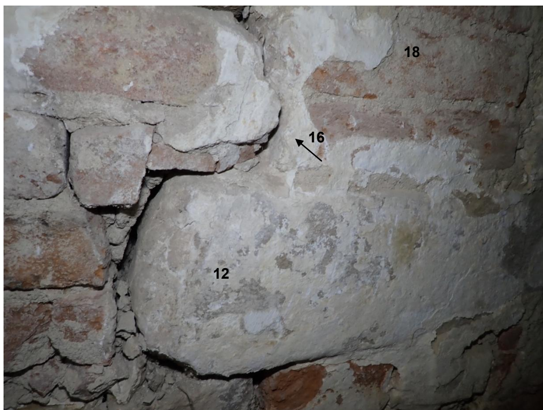
Obr. 62: Kuchyně 3. Omítka na rozhraní severní špalety a parapetu mladšího okna.
