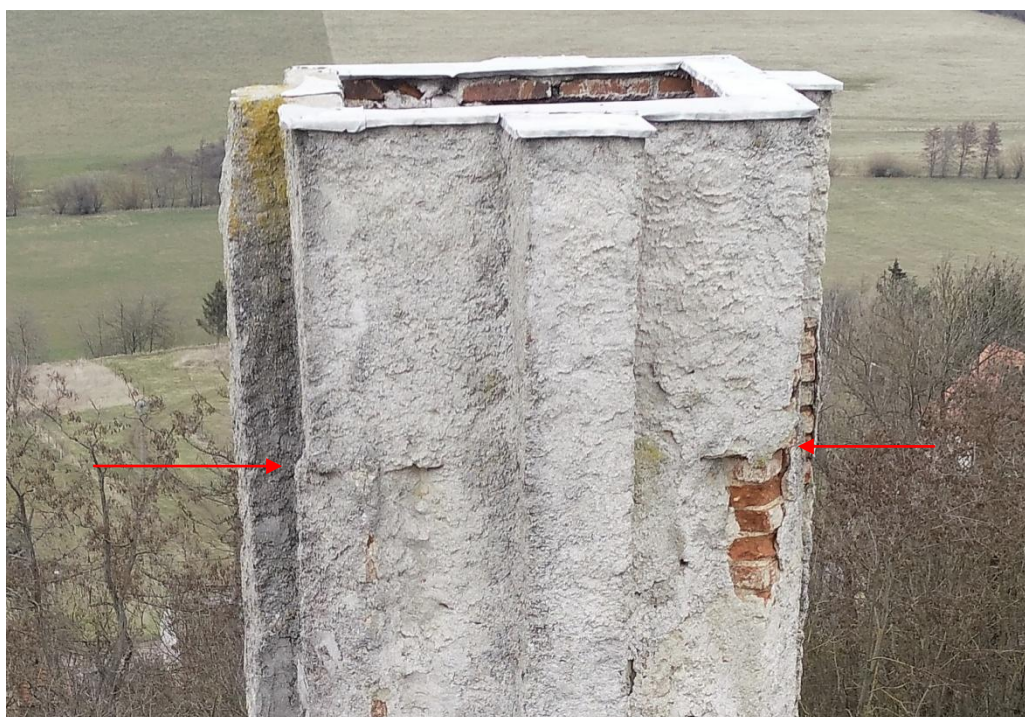
Obr. 17: Nahoře: přechody DČK - silnější manžeta nad ní - střední, užší úsek svislé části komína. Šipka označuje zešíkmení na přechodu zvolené kvůli odtékání srážkové vody (sněhu). Dole: přechod mezi středním úsekem svislé části komína a čtvercovým ústím komína. Šipky označují ukončení žeber, nad nimiž se nachází roh horního úseku svislé části komína. Foto J. Železný.
