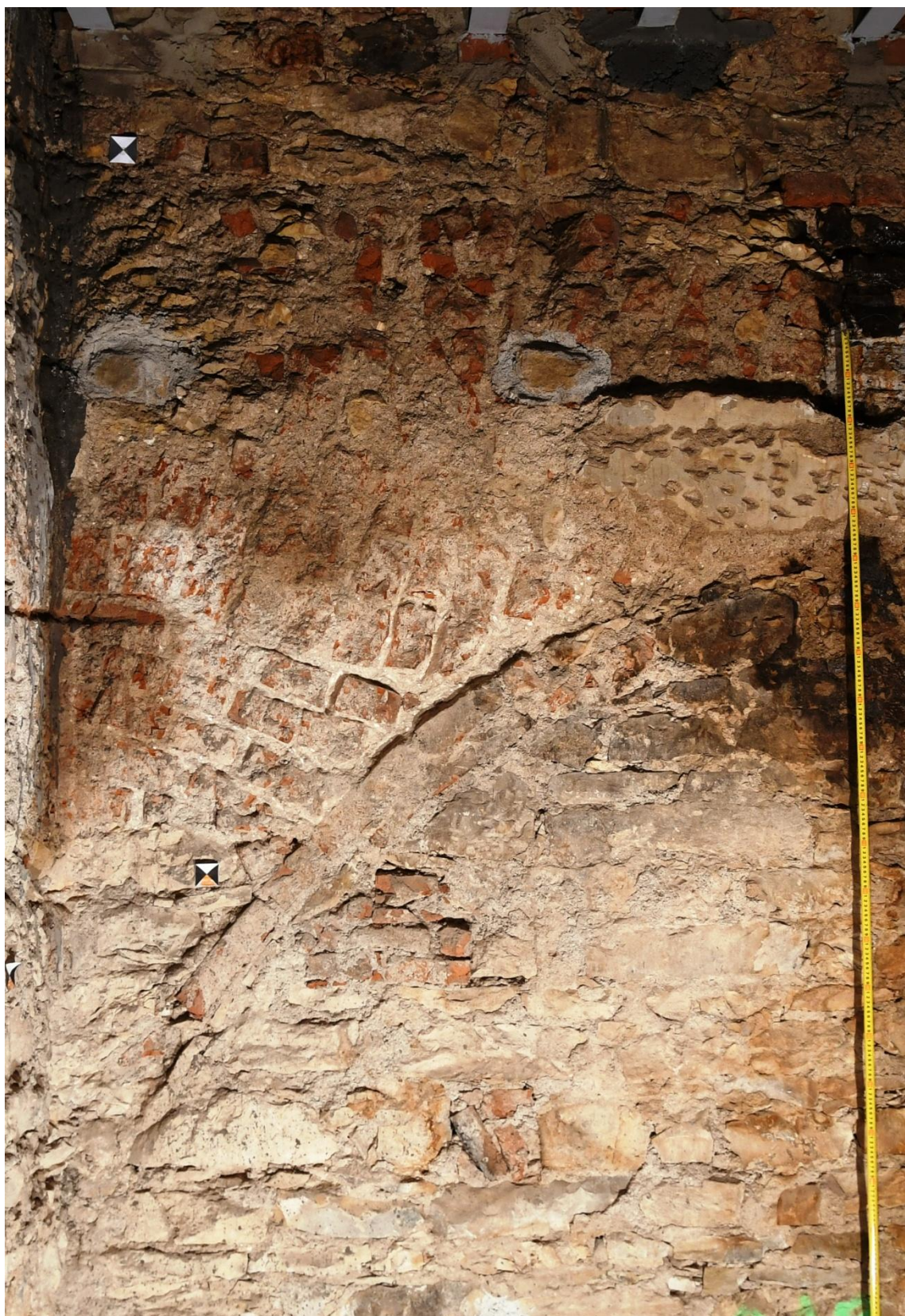
Obr. 4: Záběr na vyčištěnou stěnu kuchyně s klenbičkou. Severovýchodní roh. Je dobře rozeznatelná vyrovnávací vrstva cihel, na kamenném zdivu, spodní část pendentivu rozdělenou do 2 části, vespod z kamene, nad tím z cihel a nahoře cihlové zdivo trompu.
