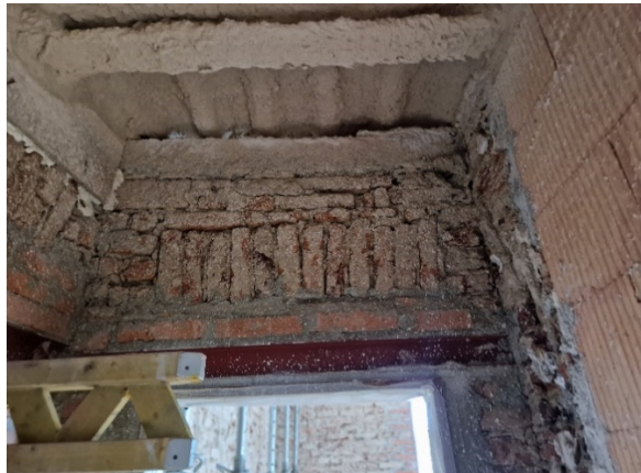
Foto č. 4: Podchycení vadného cihelného překladu (autor: I. Šimůnek)
