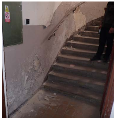
Foto 4: Vlhnutí vnitřní schodišťové stěny. Nevhodné použití neprodyšného nátěru v rámci zakrytí vlhkostní poruchy. (autor: L. Balík)
