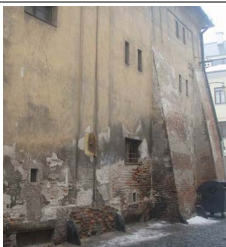
Foto 1: Kombinace vzlínající, odštěkující a dešťové vody, jež smáčí šikminy zdiva. (autor: L. Balík)
