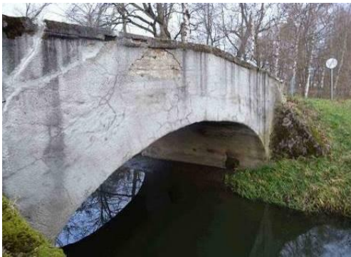
Obr. 88. Lékařova Lhota, pravděpodobně 19. stol. Degradace omítky
