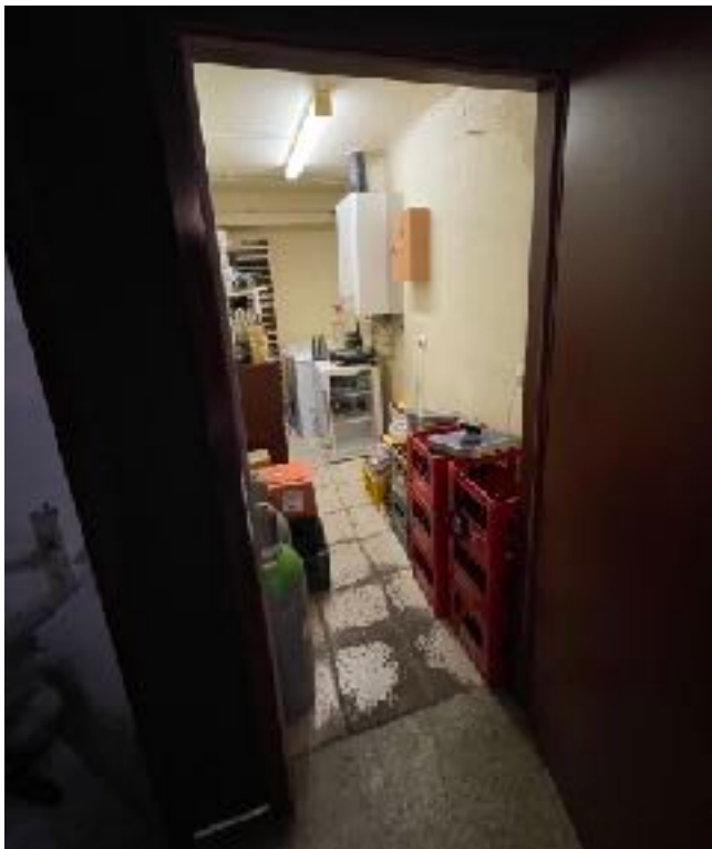
Obrázek 35 Plynový kotel zázemí severovýchodní přístavby (SOKOLOVNA CAFE&BAR)
