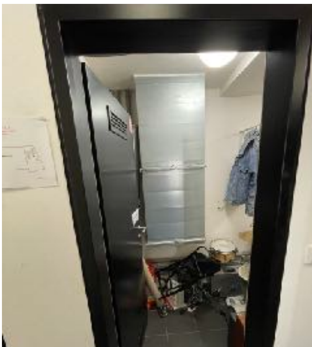
Obrázek 33 Rozvody vzduchotechniky pro sál DIODu
