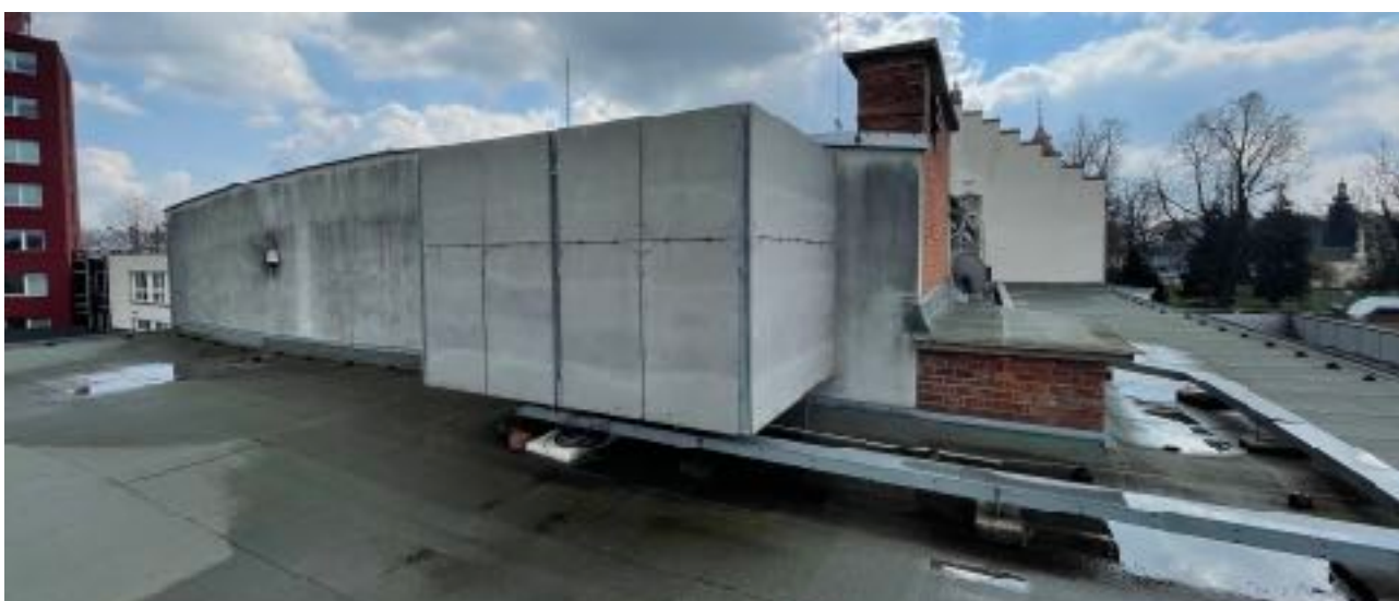
Obrázek 26 Severní pohled ze střechy na chladicí jednotku DIODU
