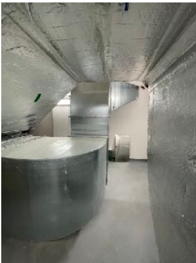
Obrázek 31 Rozvody vzduchotechniky pro sál DIODu
