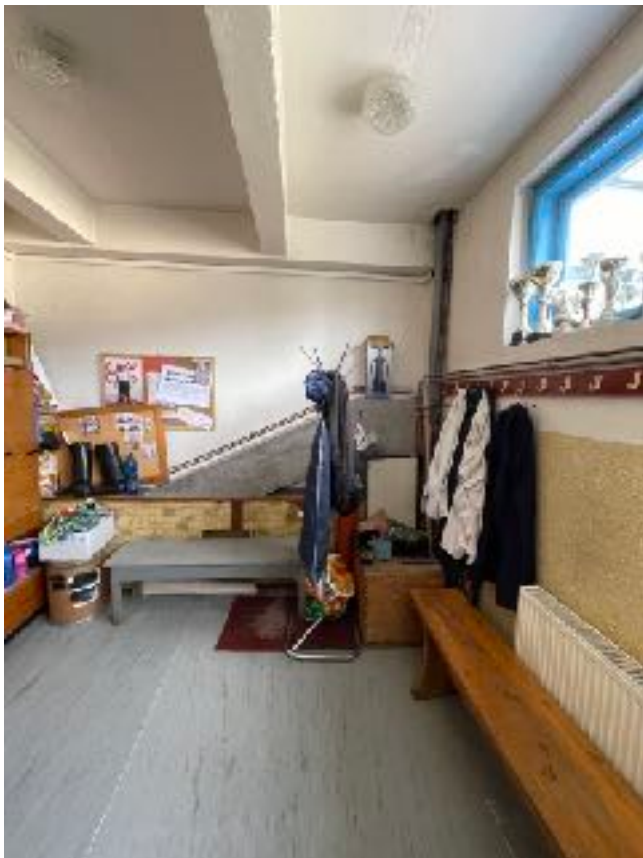
Obrázek 37 Rozvody otopné soustavy v kanceláři 2.NP (velké tepelné ztráty)
