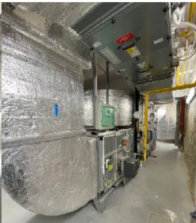
Obrázek 30 Vzduchotechnická jednotka pro sál DIOD
