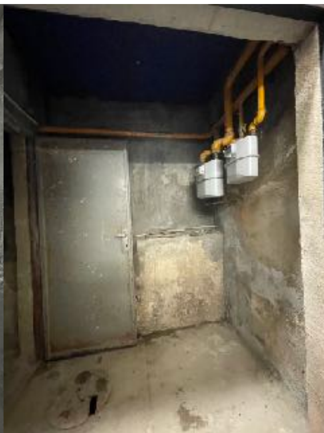
Obrázek 32 Vstup do technické místnosti VZT jednotky DIODu z ulice Tyršova
