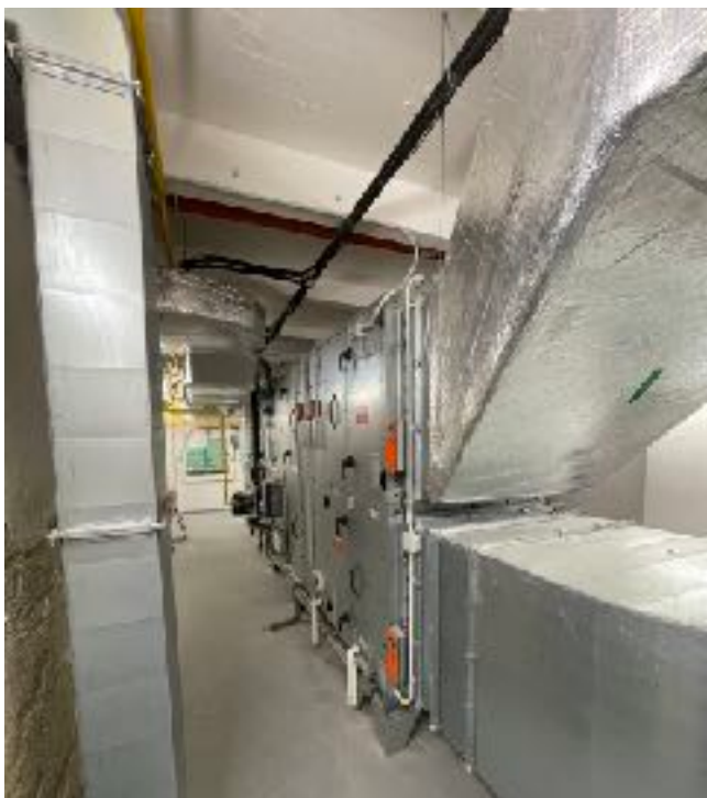
Obrázek 29 Vzduchotechnická jednotka pro sál DIOD
