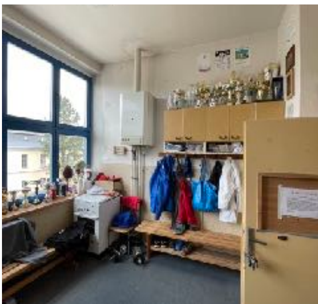
Obrázek 41 Umístění plynového kotle Thermona 28 T o výkonu 28 kW v kanceláři 3.NP
