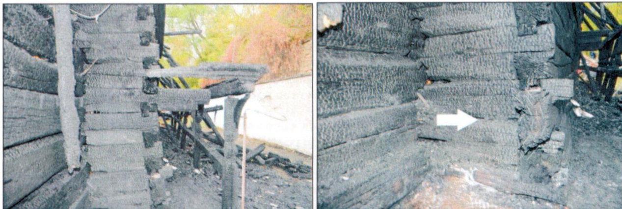
Obr. 5 a 6 – detail poškození podstrešního trámu v zóně kriminalistického ohniska a detail odhoření trámu ve srubové konstrukci
