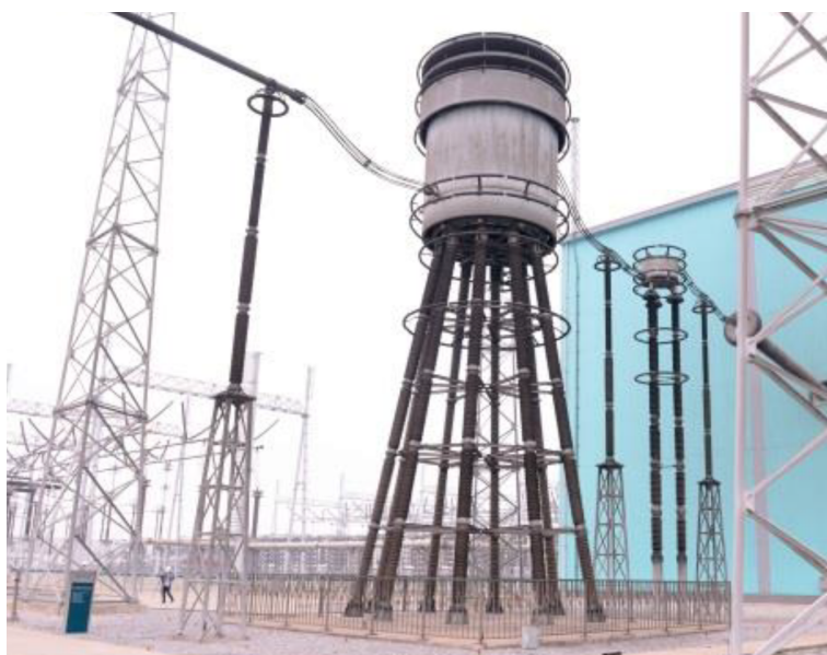
Obrázek 3.6: Vzduchová vyhlažovací tlumivka [11] Indukčnost 75 mH, jmenovité napětí 660 kV, jmenovitý proud 3030 A
