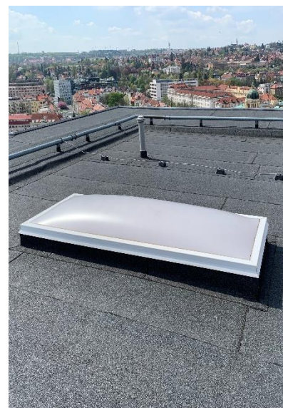
obr. 31 - Samočinně otevíratelný světlík umístěný na střeše objektu
