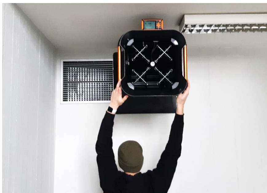
obr. 59 – Průběh měření objemového průtoku přírodního vzduchu na pravé polovině vyústky v 6. NP
