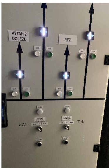
obr. 29 - Ovládací panel požárního větrání umístěný v el. požární rozvodně
