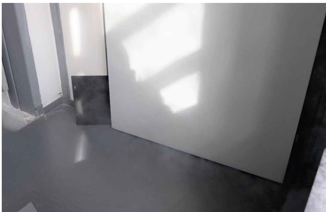
obr. 76 – Průnik kouře do prostoru CHÚC po přemístění kouřového generátoru (pro lepší viditelnost vložena černá deska formátu A4 k dveřnímu křídlu)
