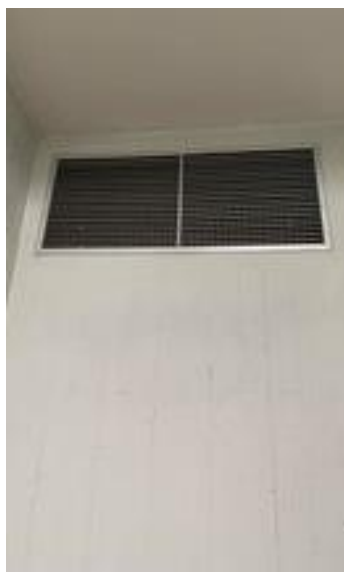
obr. 30 - Stěnová mřížová vyústka umístěná pod mezipodestou ve 3. NP
