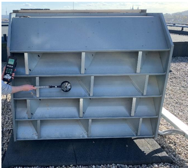
obr. 48 – Průběh měření rychlosti proudění nasávaného vzduchu v nasávacím otvoru
