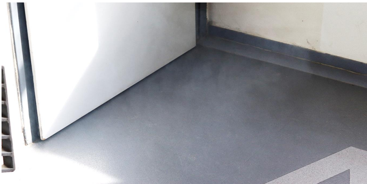
obr. 74 – Průnik kouře do prostoru CHÚC (pohled na podestu a spodní hranu dveřního křídla)
