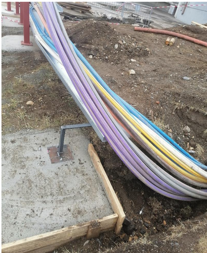
Obrázek 5; optické kabely v plastových chráničkách; vlastní zpracování
