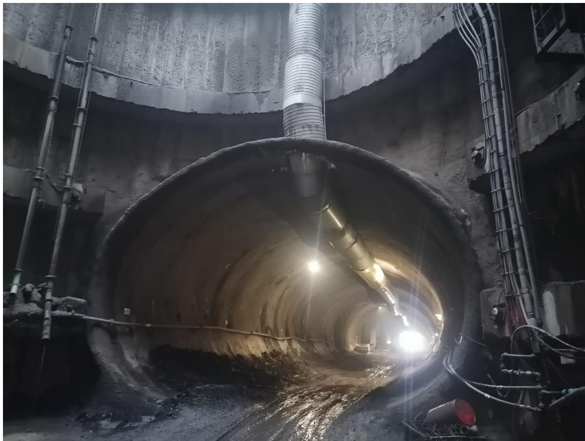
Obrázek 13; pohled z šachty, určené pro svislou dopravu vyrubané horniny, do budoucího prostoru kolejového tunelu metra D; vlastní zpracování
