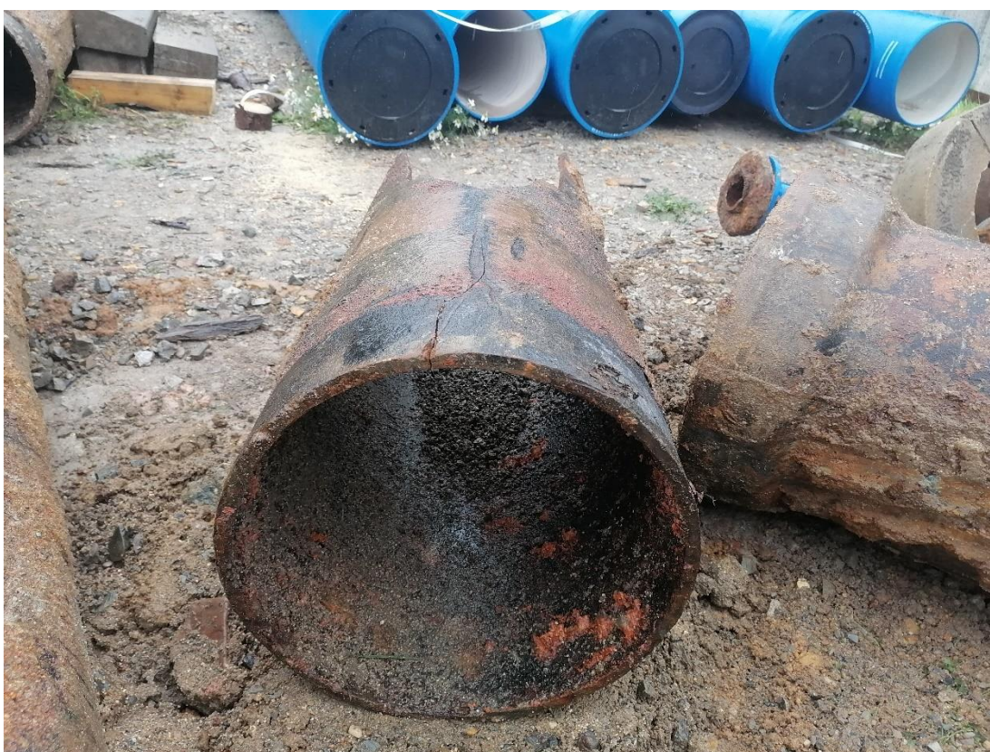
Obrázek 3; Výměna vodovodního řadu DN400, v popředí původní trouba; v pozadí nové potrubí z tvárné litiny; vlastní zpracování
