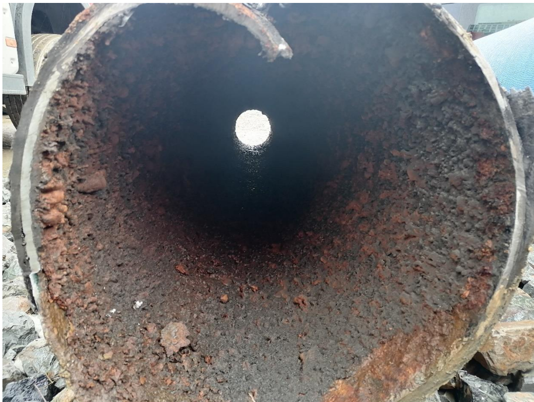
Obrázek 1; Nutnost překládat stávající IS preventivně, kvůli nedostatečným vlastnostem materiálu ze kterých jsou sestaveny
