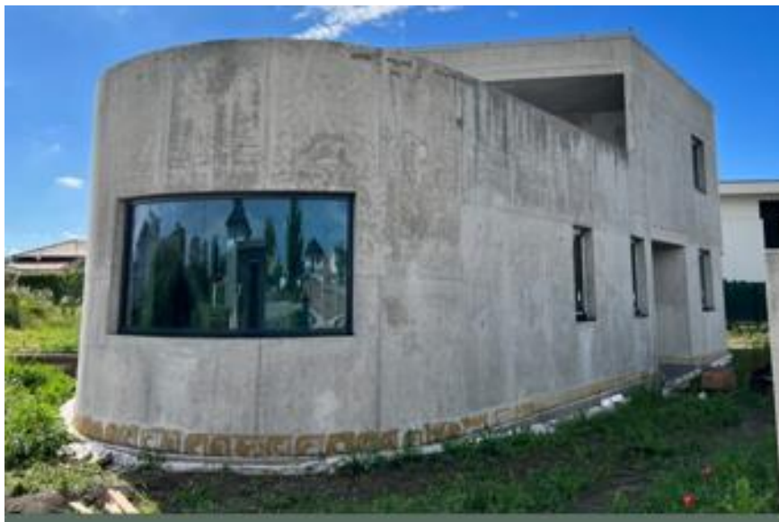
Obr. 9 – fasádní stěna s krystalizací
