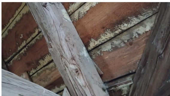
Obrázek 33: Dřevěné bednění napadené dřevokaznou houbou
