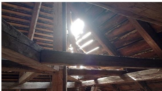
Obrázek 35: Poškozený střešní plášť v místě střešního nároží
