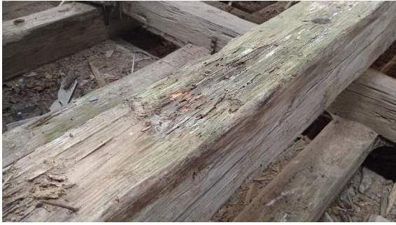
Obrázek 37: Vazný trám napadený hnilobou v prostřední části pod hřebenem
