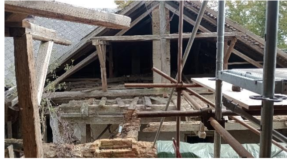
Obrázek 38: Zřícená část krovu
