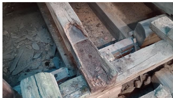
Obrázek 36: Zhlaví trámu napadené hnilobou
