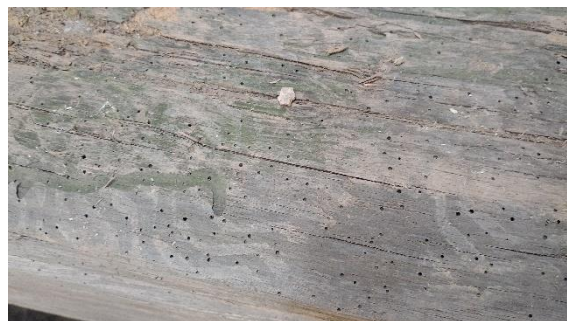
Obrázek 34: Vazný trám napadený dřevokazným hmyzem
