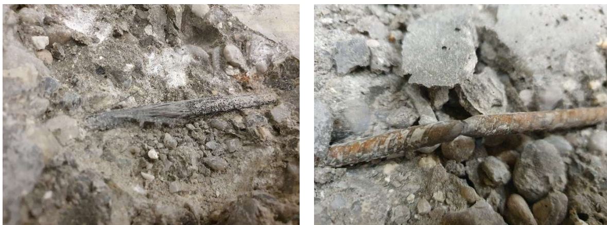
Obr. 43 – Panel 2 roztřepená kompozitní výztuž a přetržená ocelová výztuž
