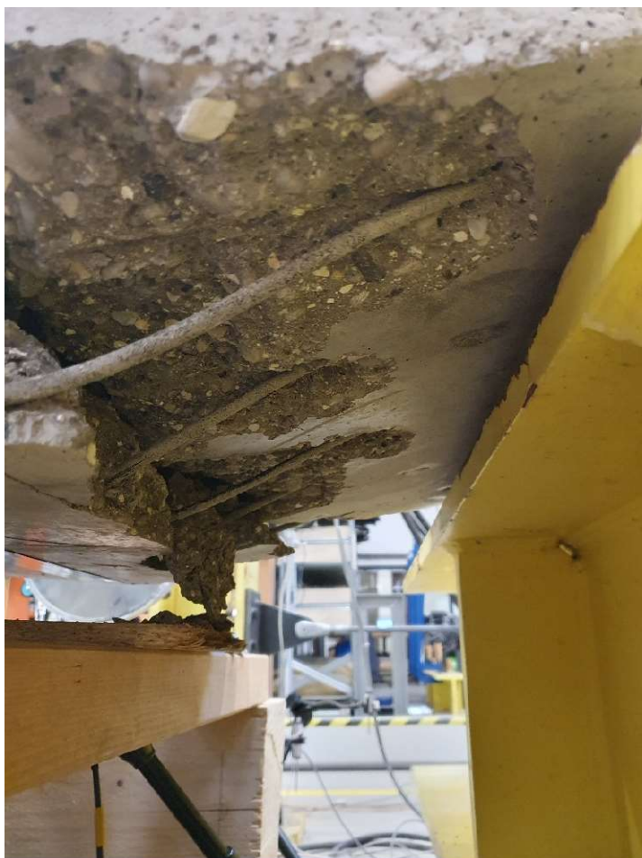
Obr. 47 – Panel 3 foto kolapsu 2
