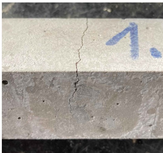
Obr. 4.14: Porušení tělesa po zkoušce pevnosti betonu v tahu ohybem
