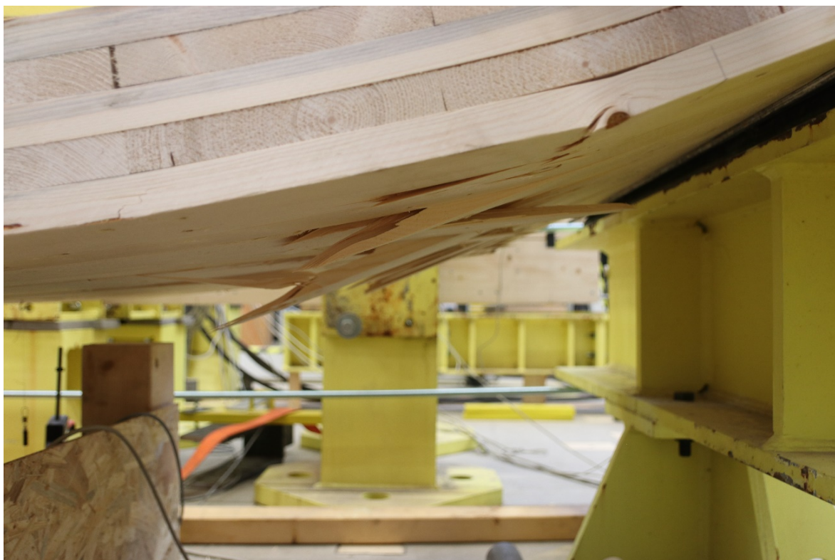
Obrázek 25: Ukázka porušení pětivrstvého panelu
