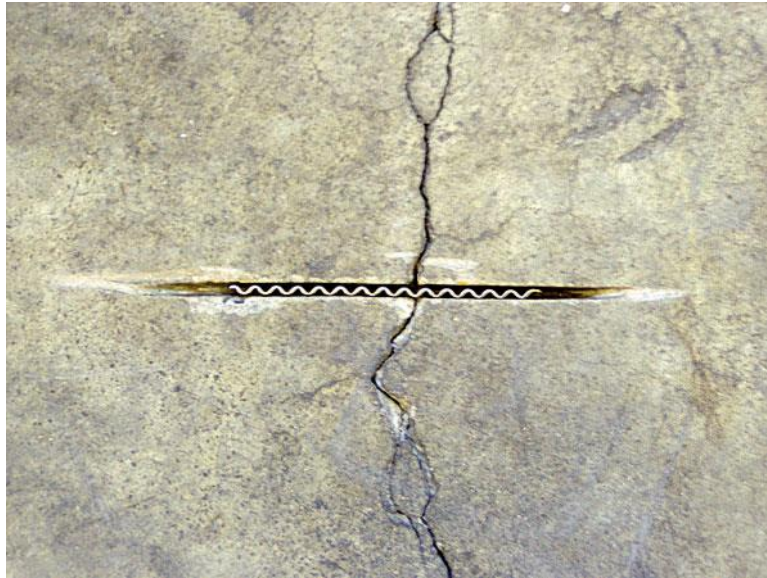
Obrázok 4.3.7 – Zošívanie trhliny pomocou oceľovej spony
