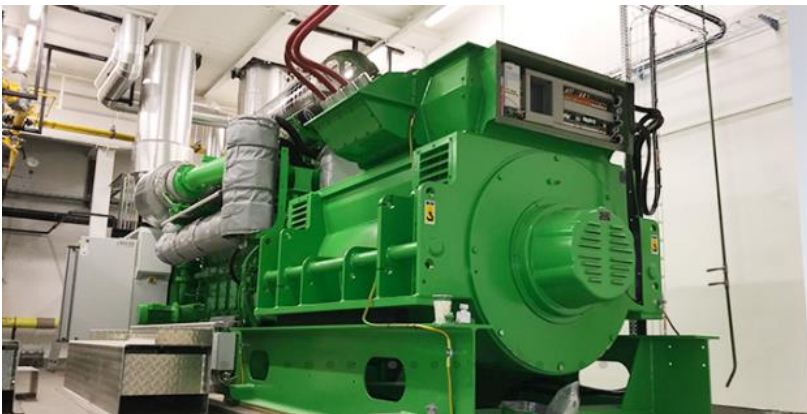
Obrázek 14 – Kogenerační jednotka VZT Nové Zámky [11]
