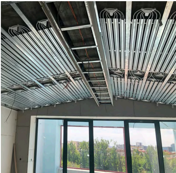
Obrázek 12: Stropní otopné/chladicí panely před zaklopením [26]
