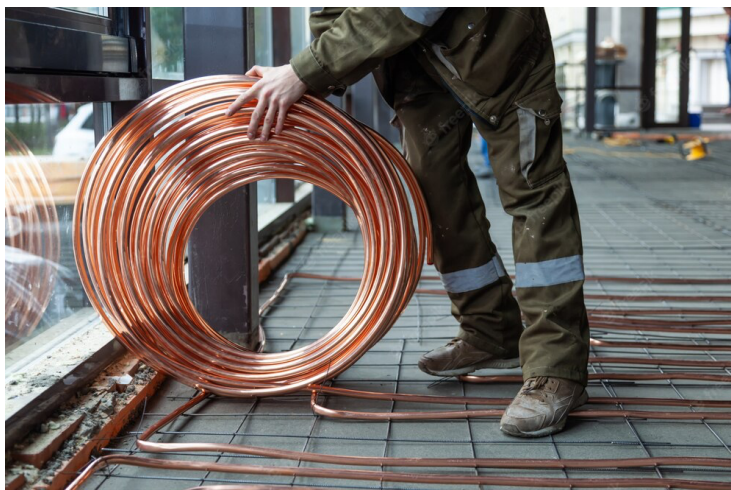
Obrázek 25: Měděné potrubí v aplikaci pro podlahové vytápění [10]
