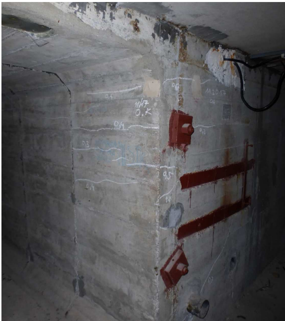
Obrázek 2.5: Trhliny příčnicku mostu D11-040..3 (HPM 28. 11. 2017, Drahorád Michal, Ing.)
