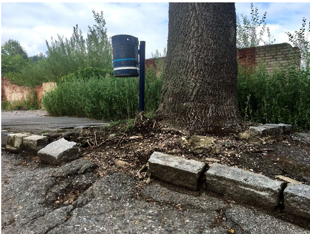
Obrázek 22 – Porucha vozovky, obrubníku a chodníku v ul. Na Dražkách
