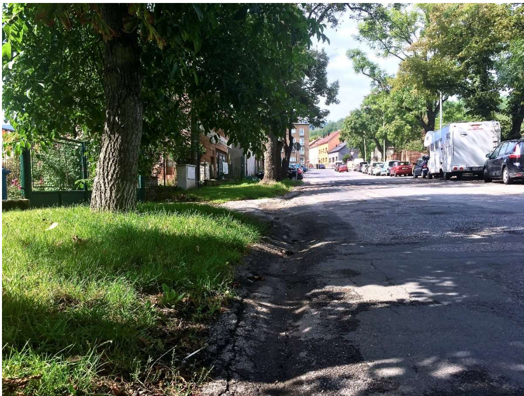
Obrázek 20 – Porucha kraje vozovky v ul. Na Dražkách
