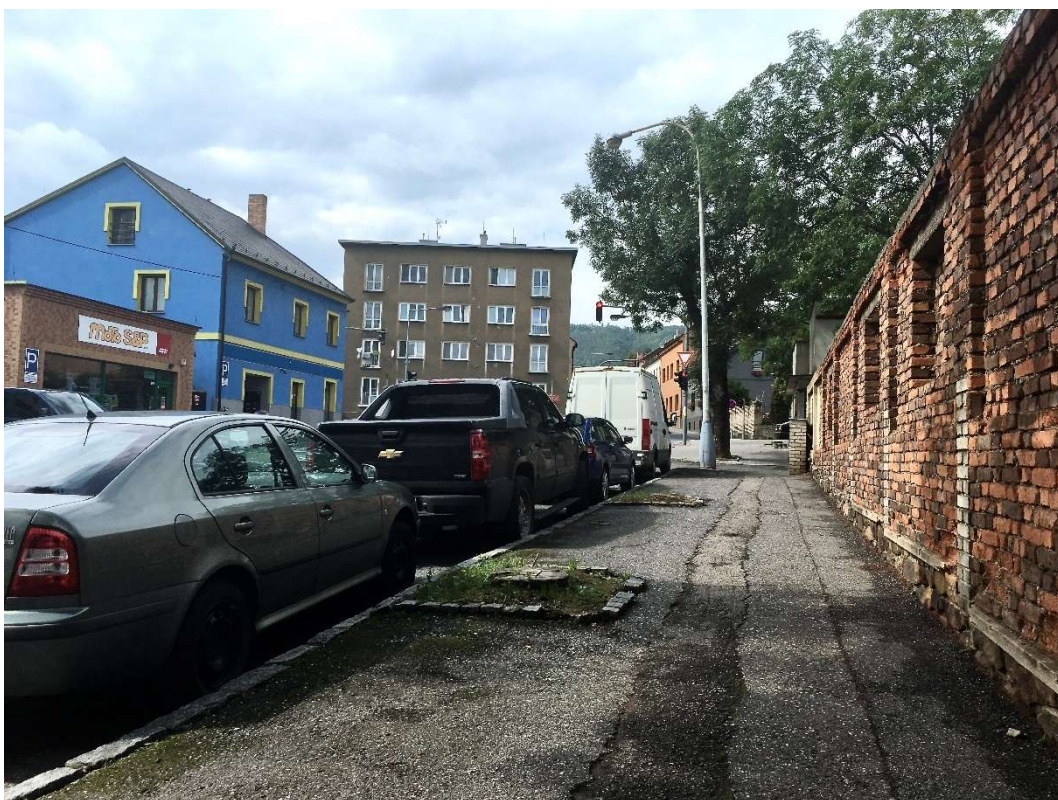
Obrázek 23 – Porucha chodníku v ul. Na Dražkách
