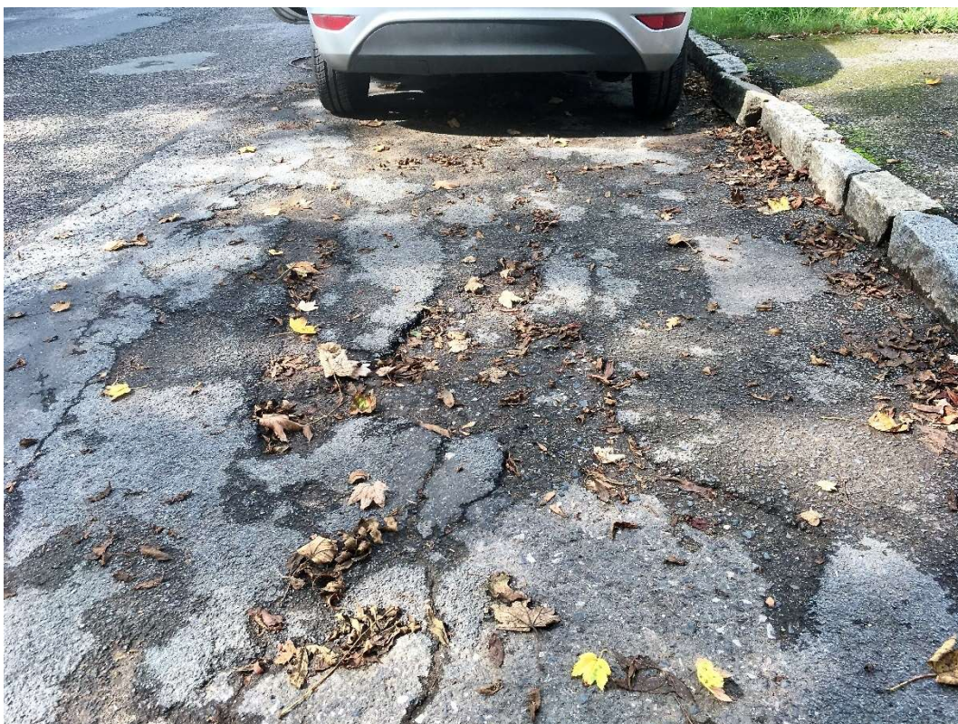
Obrázek 21 – Porucha vozovky parkovacího pruhu v ul. Na Dražkách
