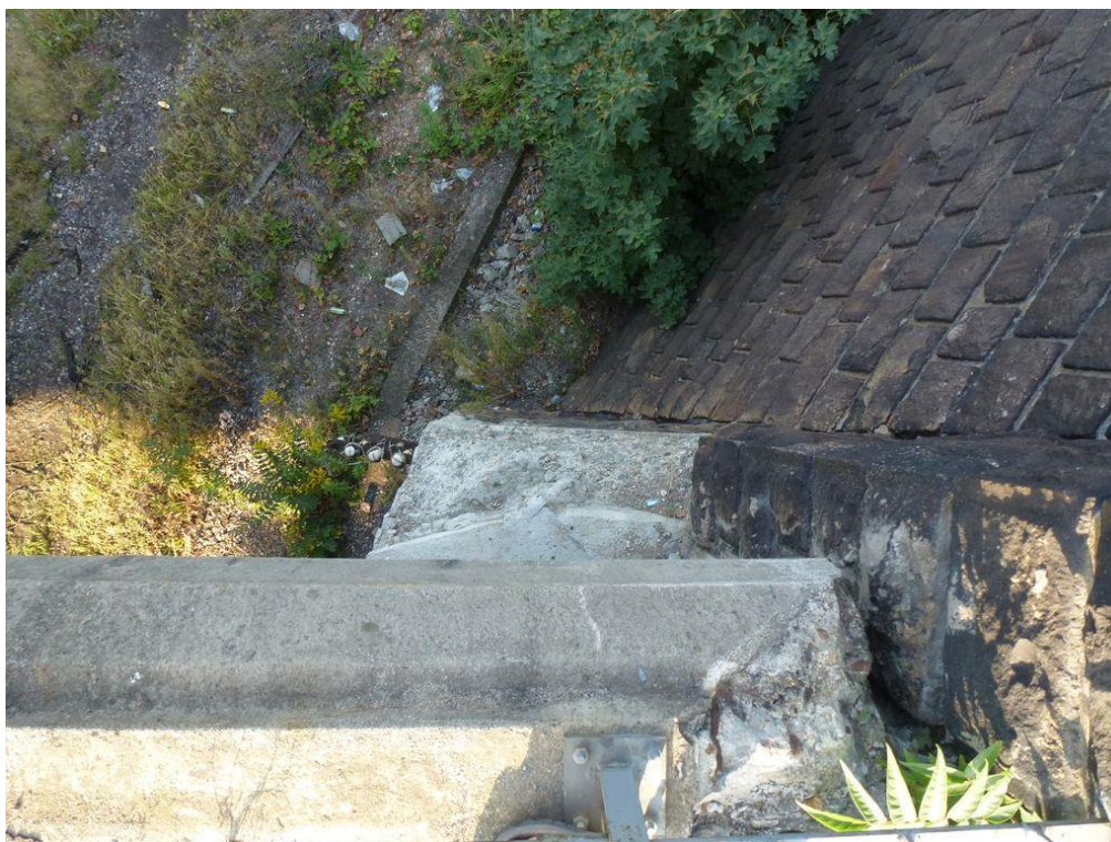
Obrázek 4: Značná hloubková degradace úložného prahu
