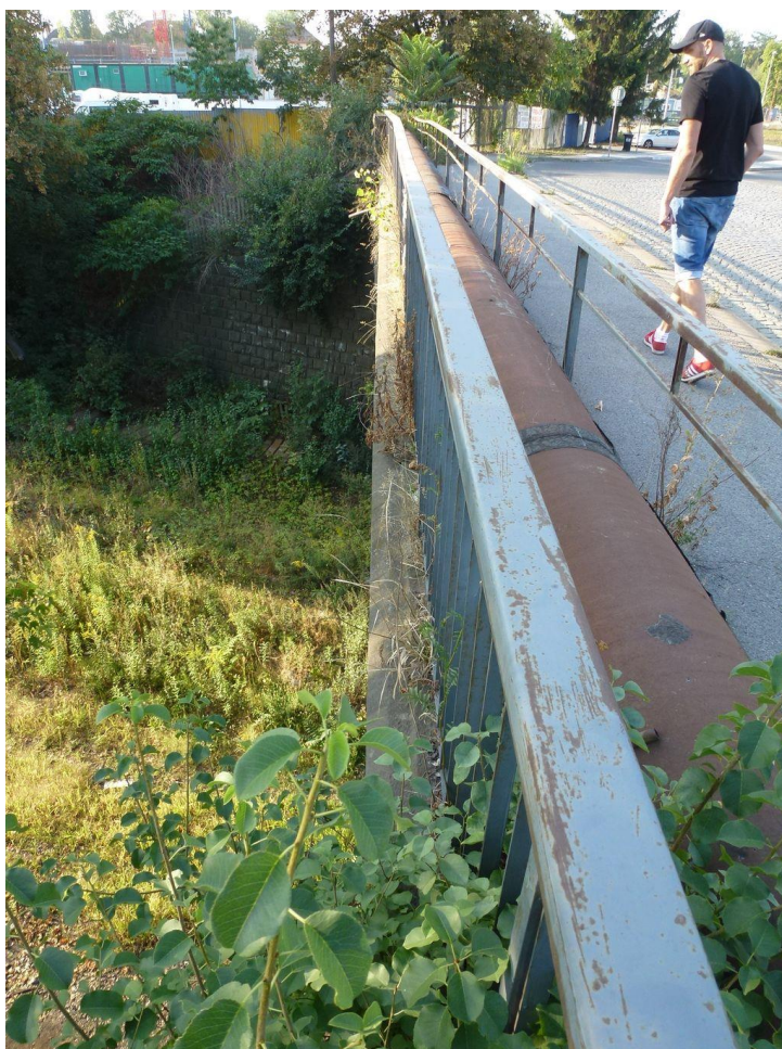
Obrázek 8: Patrná koroze zábradlí a zasažení říms vegetací
