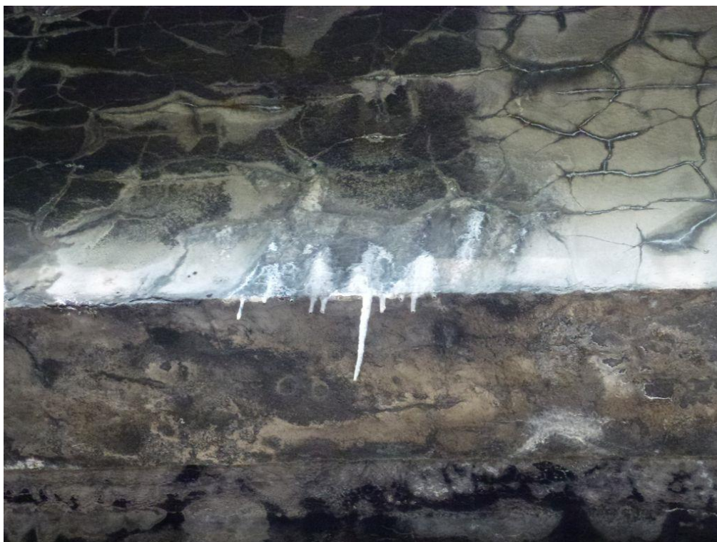
Obrázek 5: Pohled na nosníky s patrnými stopami zatékání
