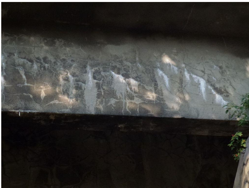
Obrázek 7: Patrné zasažení celého spodního povrchu zplodinami dieslové trakce
