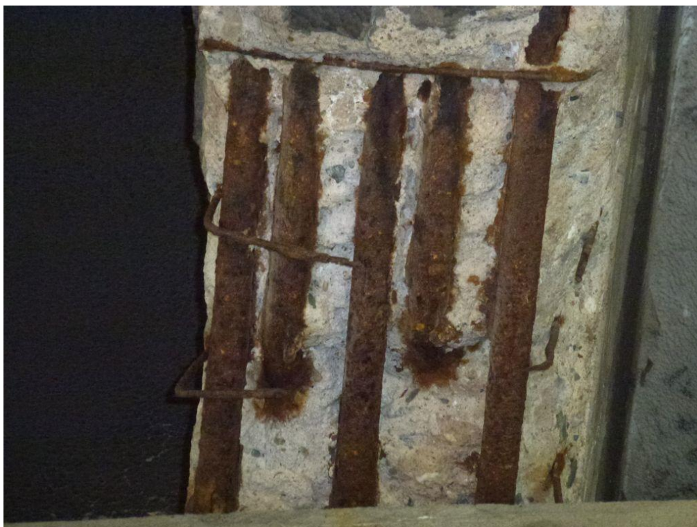
Obrázek 6: Obnažená betonářská výztuž nosníku
