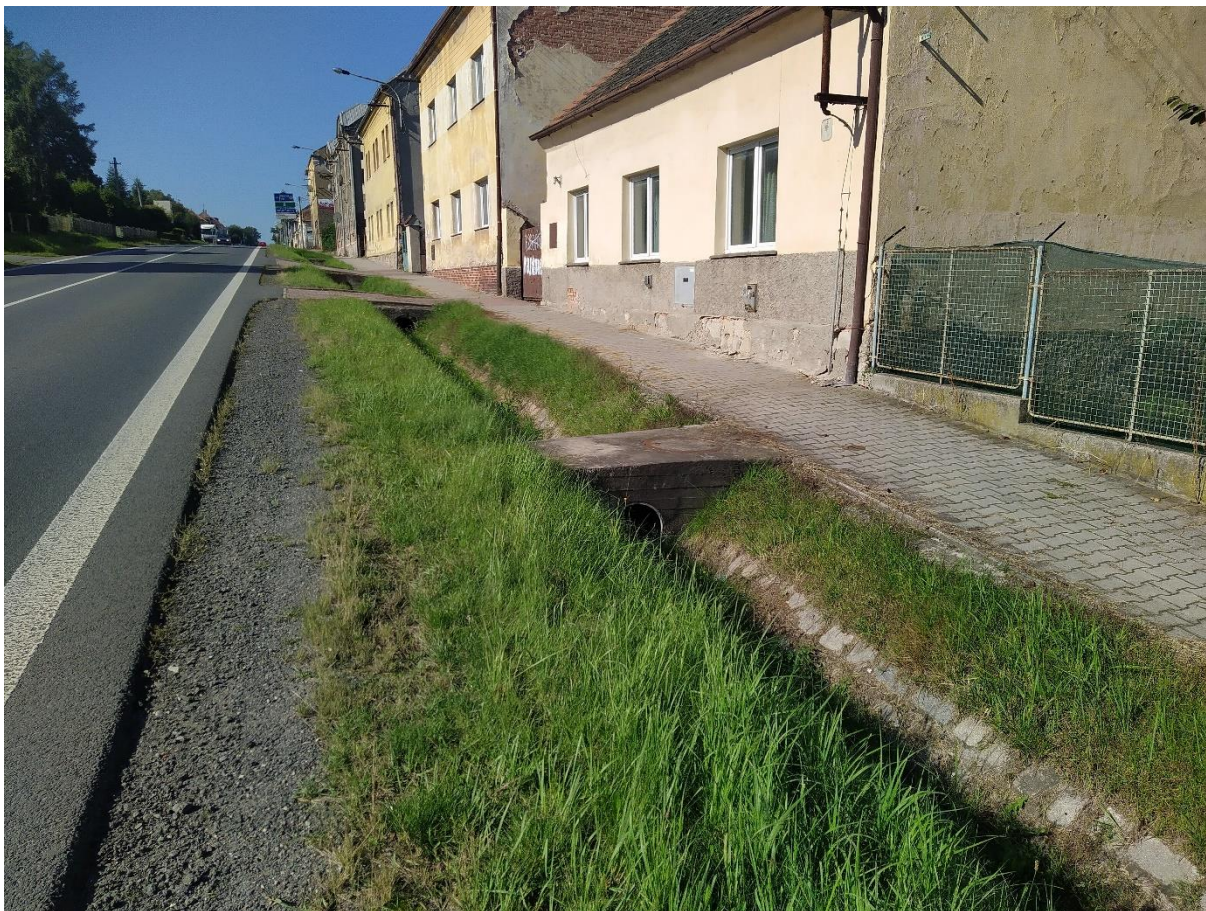
Obrázek 18 – Čela propustků tvořící pevné překážky
