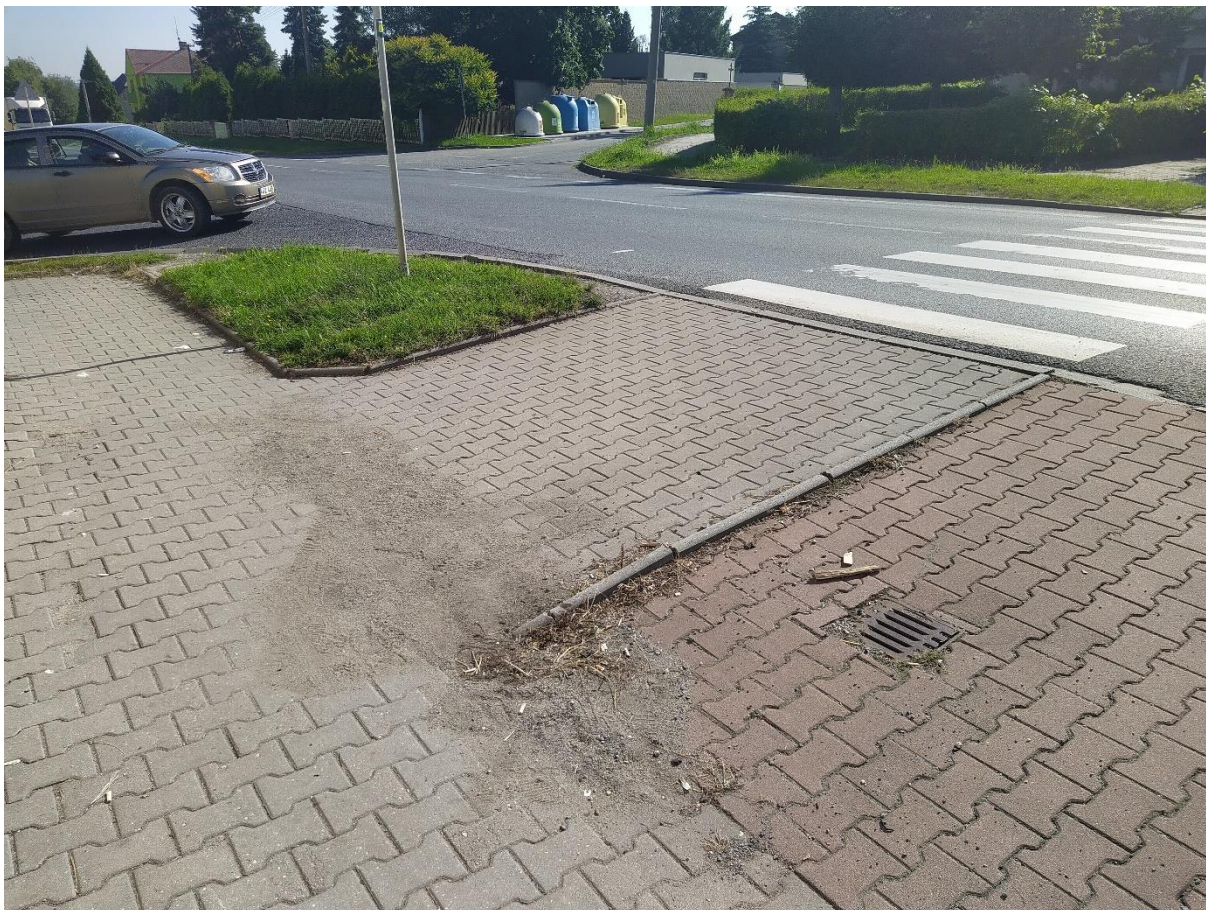
Obrázek 27 – Chybějící bezbariérové úpravy
