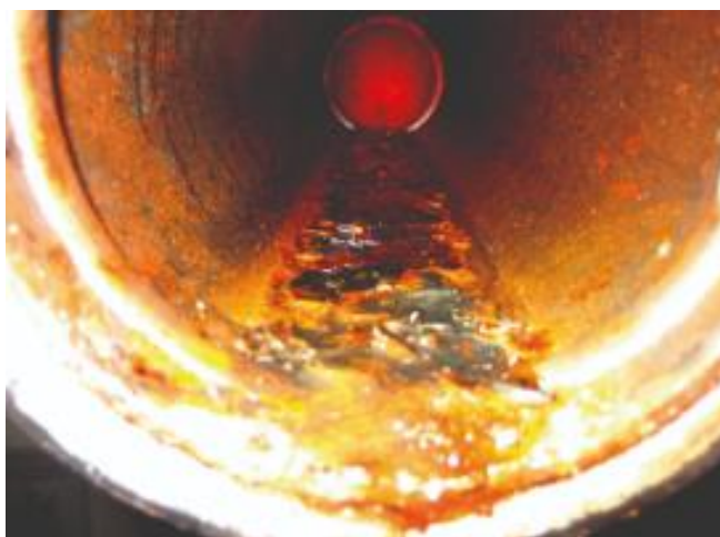
Obr. 11: Koroze uvnitř ocelového SHZ potrubí [11].
