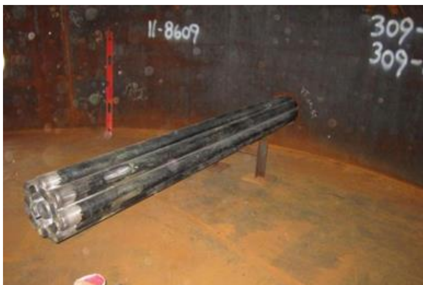
Obr. 14: Ponorný ohříváč uvnitř nádrže [14].
