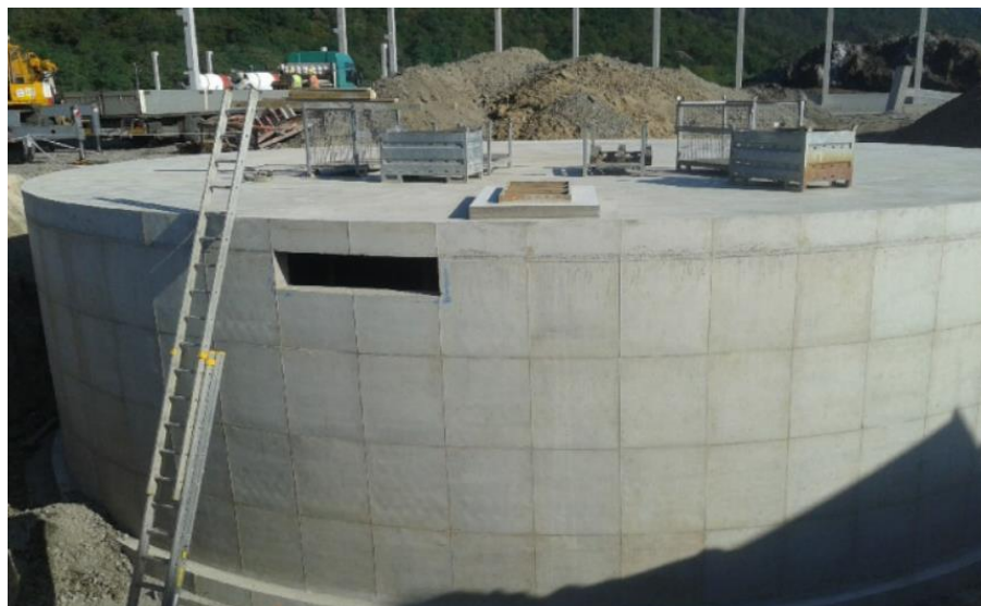
Obr. 7: Podzemní zásobní nádrž [9].
