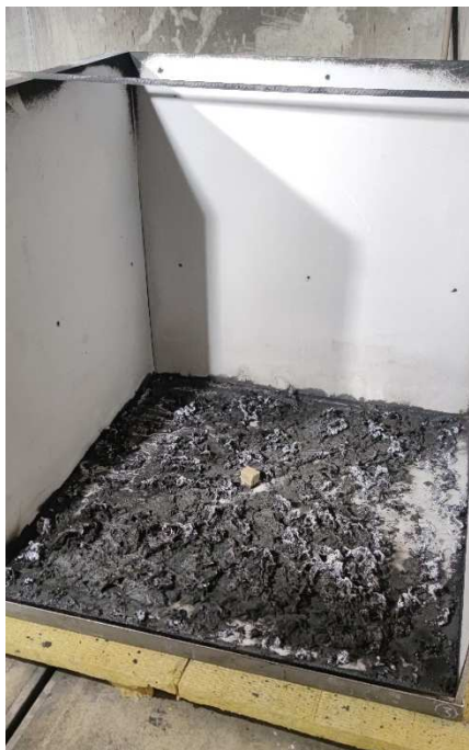
a) Zbytky paliva po odstranění boční stěny
