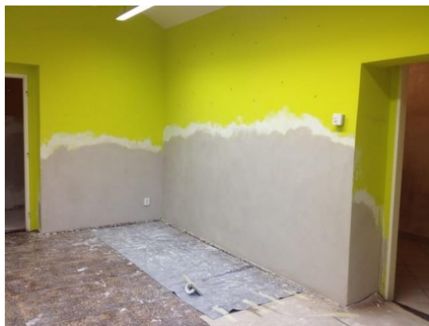
Obrázek 9 - Sanační omítka 2 (Zdroj: https://suche-domy.cz/wp-content/uploads/2020/01/IMG_0210.jpg )
