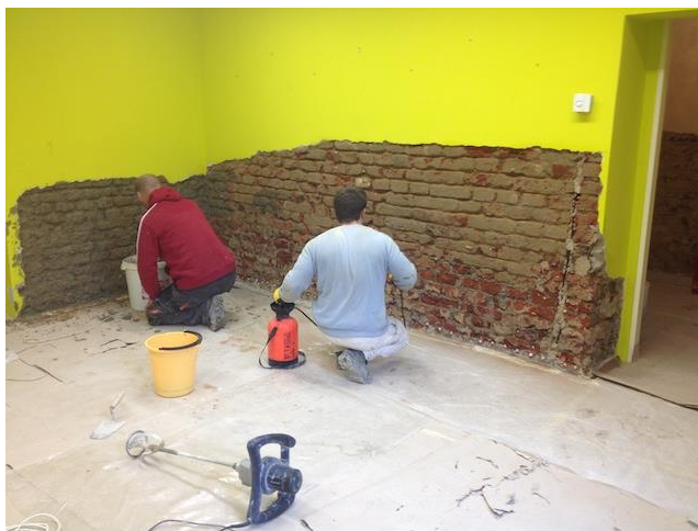
Obrázek 8 - Sanační omítka 1 (Zdroj: https://suche-domy.cz/wp-content/uploads/2020/01/IMG_0142.jpg )
