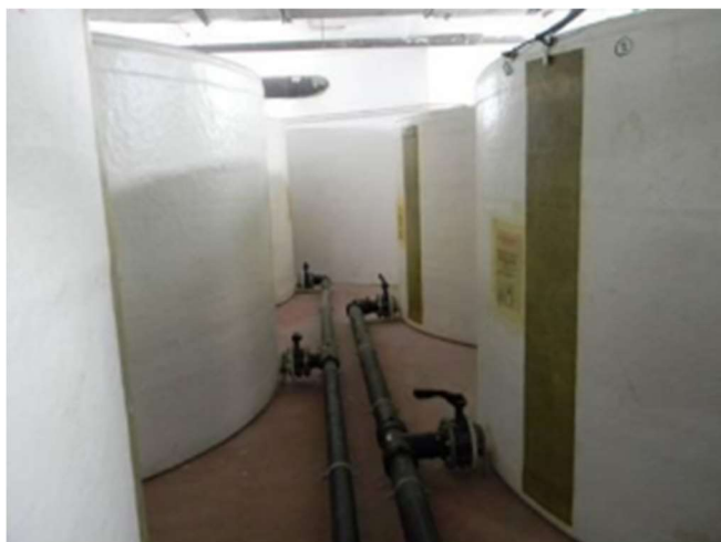
Obrázek č.13 Akumulační nádrže [37]
