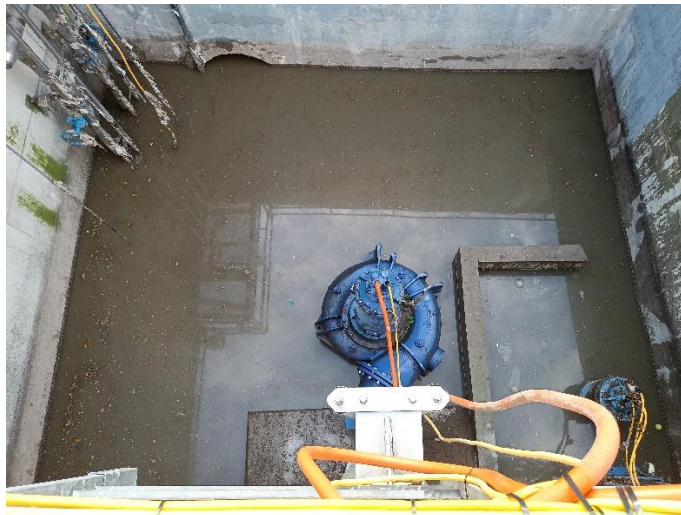
Obr. 6.1 a 6.2: Spouštění čerpadla v akumulční nádrži na ČOV Pečky k odlehčení OV do recipientu, foto: Lenka Langhammerová, 8.9.2022
