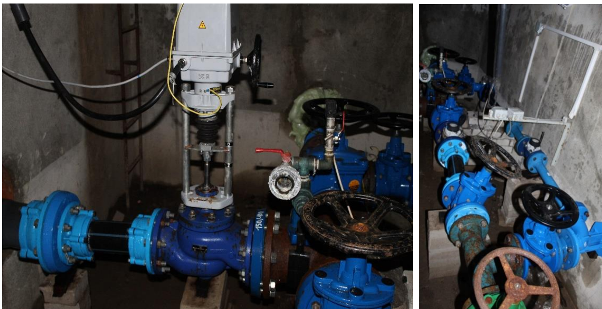
Obrázek 60. Armaturní šachta pro VV Smečno
