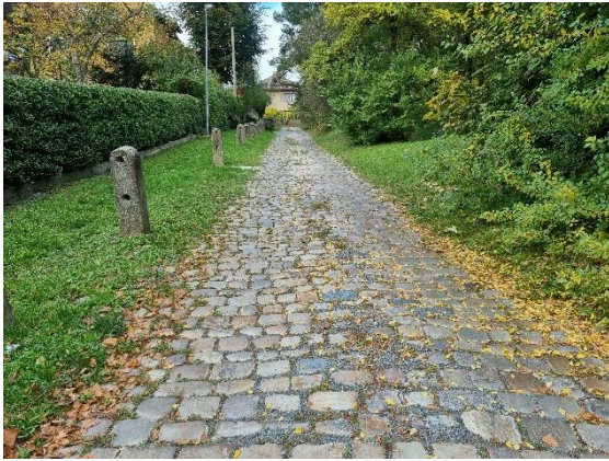
Obr. 66: Nevyhovující povrch komunikace 90
