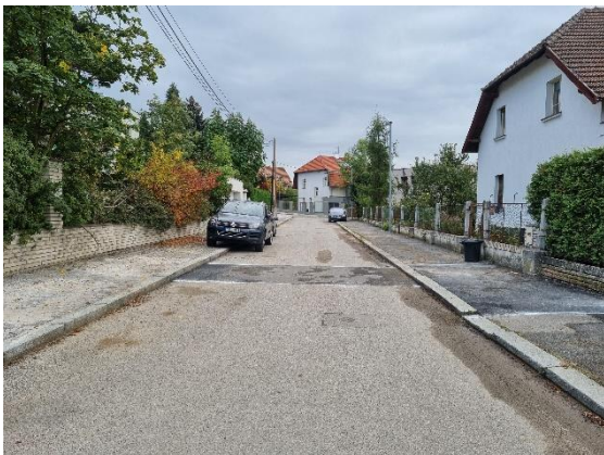
Obr. 51: Nedostatečný průjezdný profil (Stání vozidel) 71
