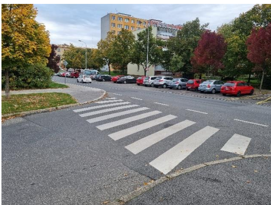
Obr. 8: Chybějící vodorovné značení pro OSSPO 12
