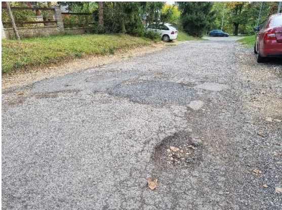
Obr. 59: Nevyhovující povrch komunikace 82
