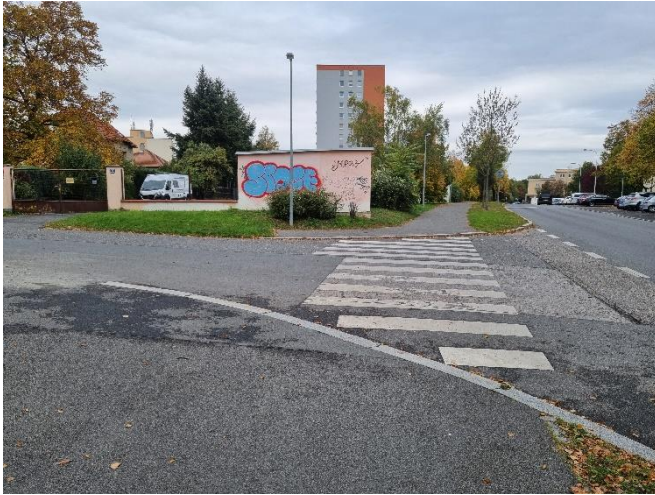
Obr. 26: Chybějící vodorovné značení pro OSSPO 33
