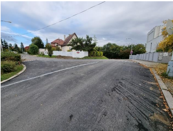
Obr. 17: Příliš rozlehlá křižovatka, Chybějící přechod pro chodce nebo místo pro přecházení 22
