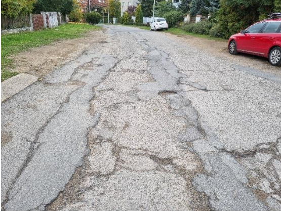
Obr. 48: Nevyhovující povrch komunikace 65
