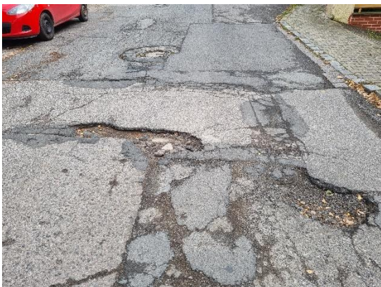
Obr. 43: Nevyhovující povrch komunikace 57
