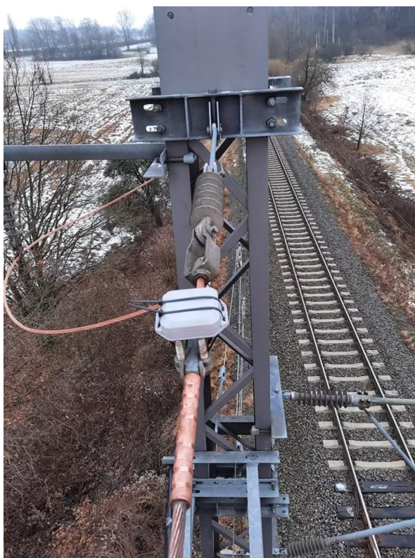
Obrázek 11 a 12. Umístění jednotky na trakčním vedení [Firma Intesys]
