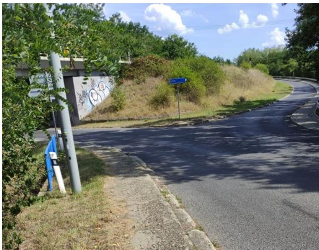
Obrázek 32 Chybějící VDZ, špatný stav chodníku a chybějící SDZ "C2c – Přikázaný směr jízdy vlevo"
