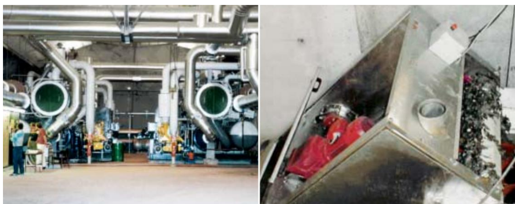
Obrázek 14: 2x TČ Unitop 28C, Mechanická filtrace odpadní vody
