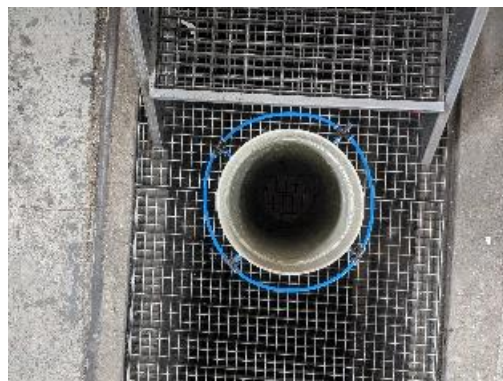
Obr 46 Tlakový odběr pohled dovnitř
