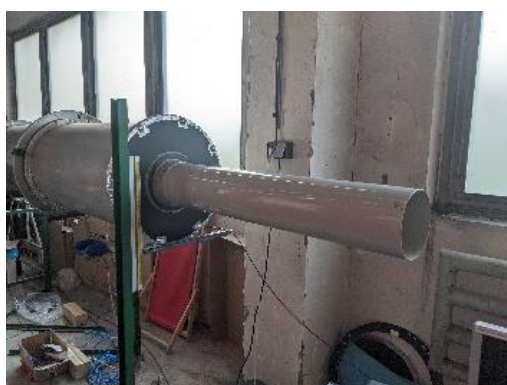
Obr 43 Přechod na průměr 500 mm
