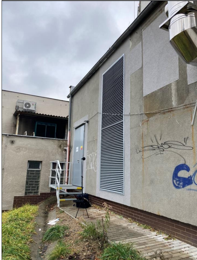
Obr. 18 Měřicí bod 1, cílem bylo určit hluk generovaný PDŽ na odvodu vzduchu ze strojovny
