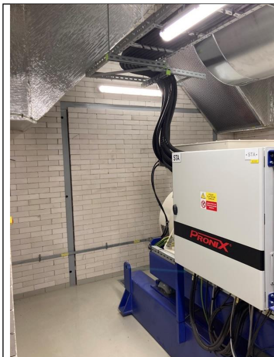
Obr. 8 Přívod vzduchu u stropu strojovny
